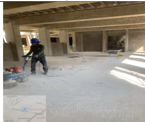
Destronque De piso en aula múltiple- comedor piso 1 sector 2
