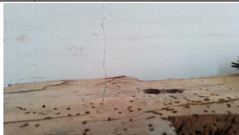
Afectación por xilófagos – prueba con alambre insertado dentro de los agujeros.
