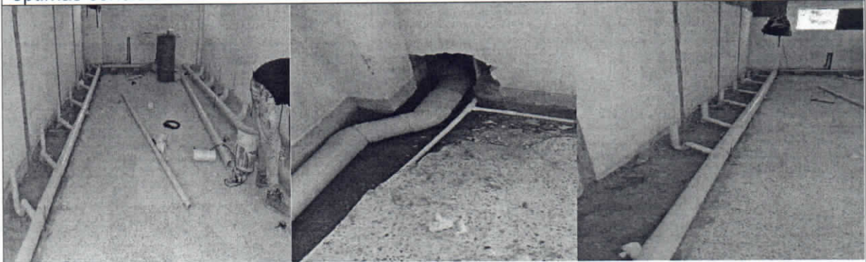
Reposición e instalación de tubería sanitaria en PVC de 4, reposición e instalación de puntos de agua fría, reposición e instalación de salida sanitaria 2.
