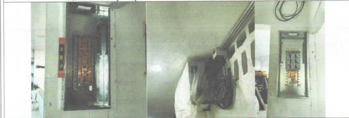
Mantenimiento y/o reposición e instalación de tablero TRIF.C/PUERTA ESP. TOTAL.24 CTOS, Mantenimiento y/o reposición e instalación de Breakers 2X30 amperios y Mantenimiento y/o reposición e instalación de Caja de paso 15 x 15 x 10 cm con chapa.
