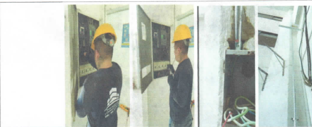
Mantenimiento y/o reposición de acometida en cable de cobre 3F No 4 +1N No 6 y/o elementos necesarios para dejar estas redes en óptimas condiciones de funcionamiento y que cumpla con las especificaciones establecidas.
