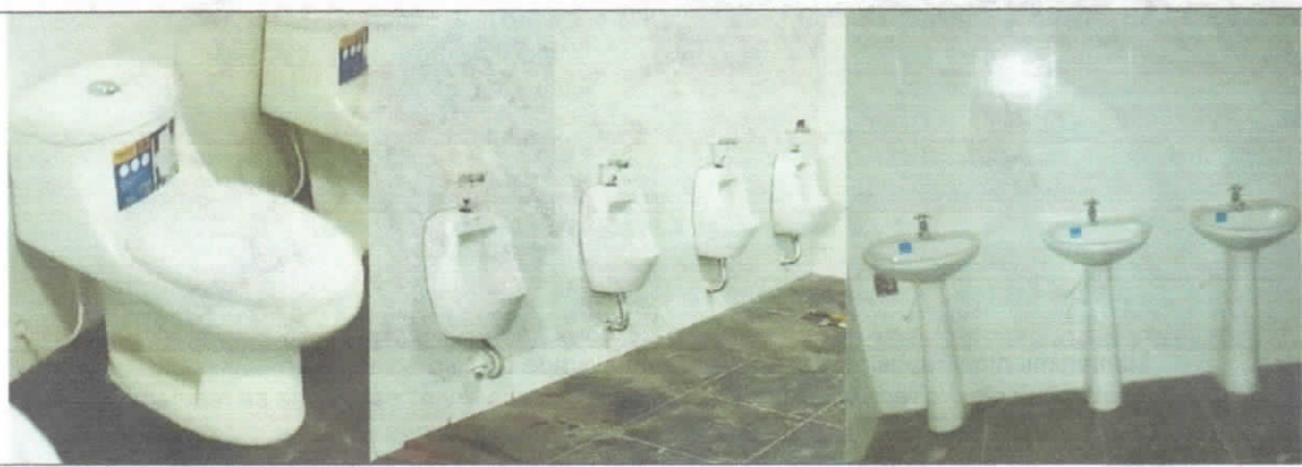
Reposición e instalación de inodoro alargado o redondo de una pieza en porcelana, con descarga variable y Reposición e Instalación de Orinal de entrada superior con esmalte antibacterial y diseño ahorrador de agua y Reposición e Instalación de Lavamanos de pedestal con amplio pozo color por definir.
