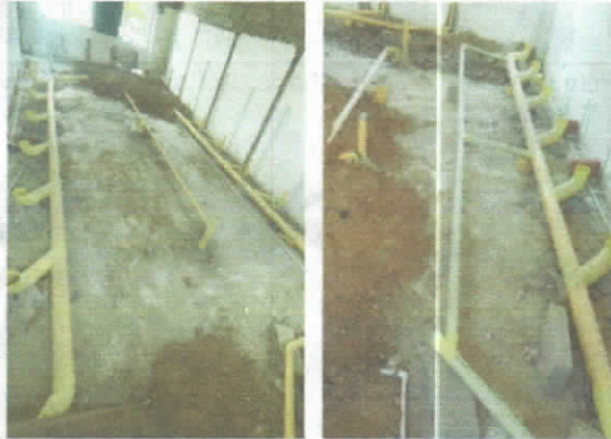
Reposición e Instalación de Tubería sanitaria PVC 4" (incluye accesorios) y Reposición e instalación de salida sanitaria 2" y 4"
