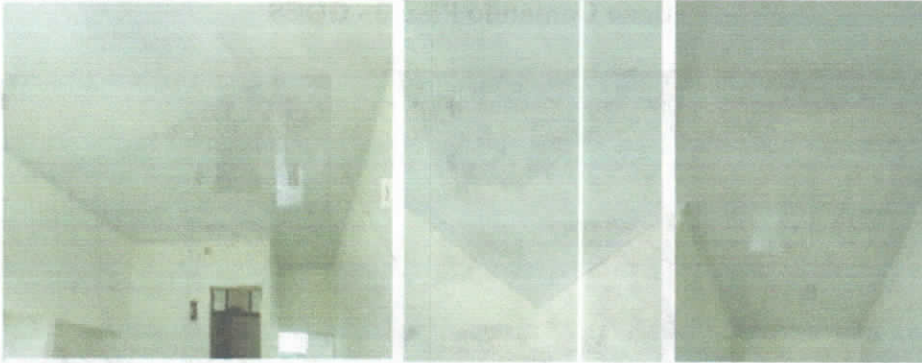
Suministro e instalación de cielo raso con tablilla en PVC. Incluye estructura metálica.
