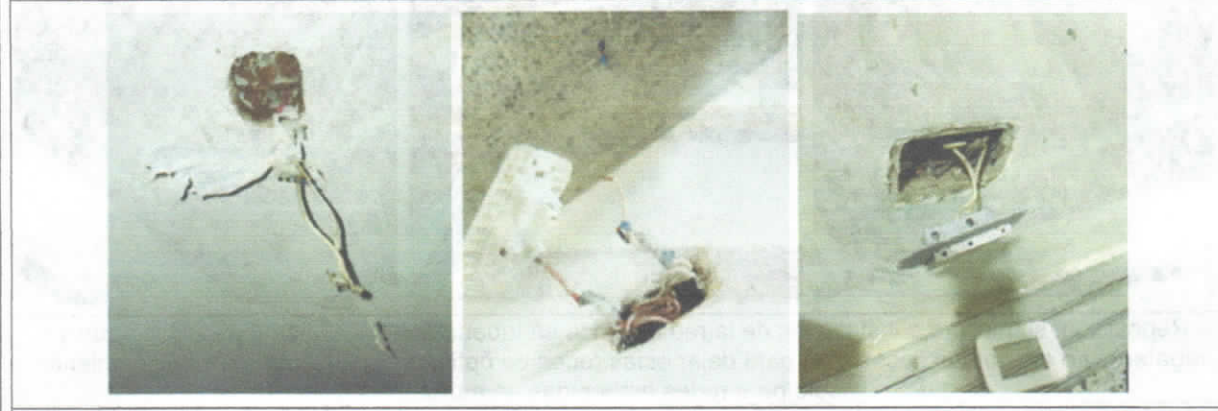
Desmante de salida eléctrica. Incluye retiro de aparato, caja, tapa, tubería y cableado hasta 1,5 m y regateo a que haya lugar
