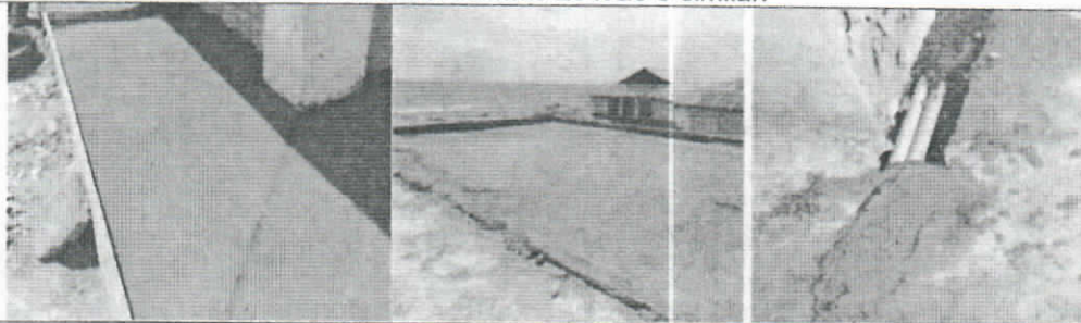
Mantenimiento y reposición e instalación de alistado de piso 4cm impermeabilizado y Reposición e instalación de mortero 1:3
