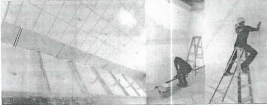
Mantenimiento y/o reposición e instalación poyo ducha en los casos que se requiera y Mantenimiento y reposición e instalación de estuco.
