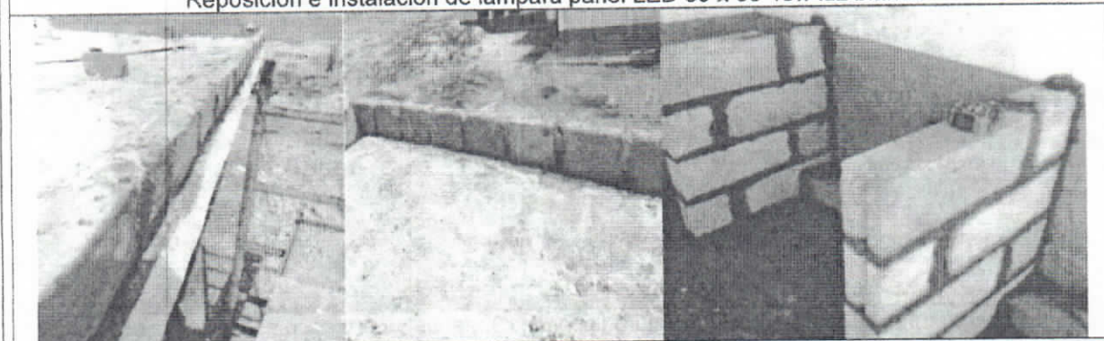
Mantenimiento y/o reposición e instalación de alfajía en ladrillo macizo prensado y Mantenimiento y/o reposición e instalación de muro divisorio bloque estriado N°4 en los casos que se requiera.
