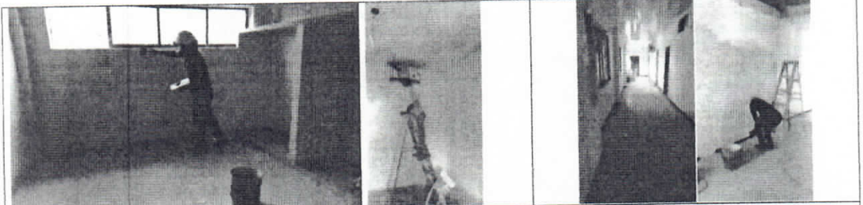
Mantenimiento y/o reposición e instalación anti humedad fachada dos capas Mantenimiento y reposición e instalación de estuco
