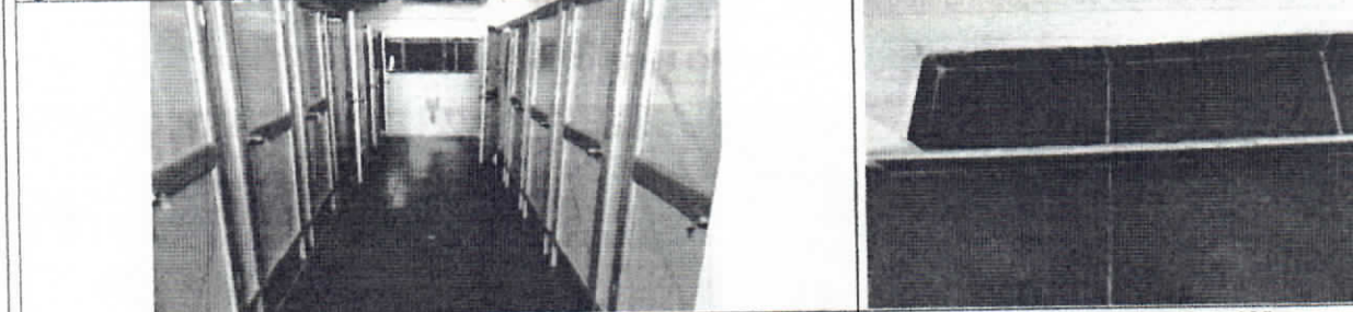
Mantenimiento y reposición e instalación de división en aluminio y lámina plástica. Suministro e instalación Win en Aluminio.
