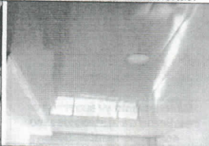
Suministro e instalación de cielo raso con tablilla en PVC. Incluye estructura metálica.
