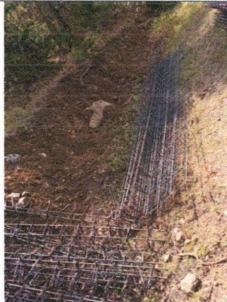
Suministro y figurado de acero de refuerzo de 4200 mpa para placas, vigas, cunetas y bordillos.
