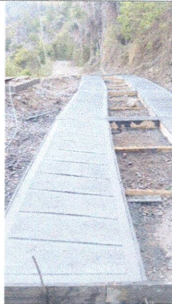
Suministro e instalación de concreto de 3.000 psi para estructuras de placa huella
