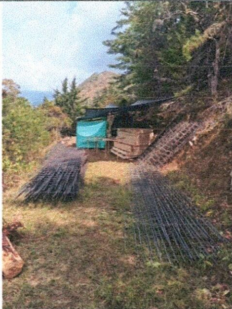
Suministro y figurado de acero de refuerzo de 4200 mpa para placas, vigas, cunetas y bordillos.
