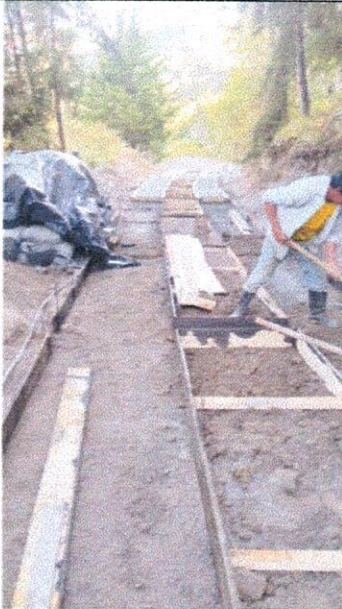
Suministro e instalación de concreto de 3.000 psi para estructuras de placa huella
