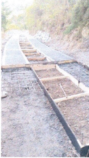
Suministro e instalación de concreto de 3.000 psi para estructuras de placa huella
