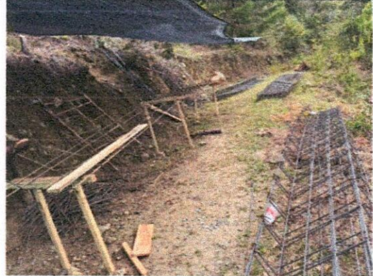
Suministro y figurado de acero de refuerzo de 4200 mpa para placas, vigas, cunetas y bordillos.
