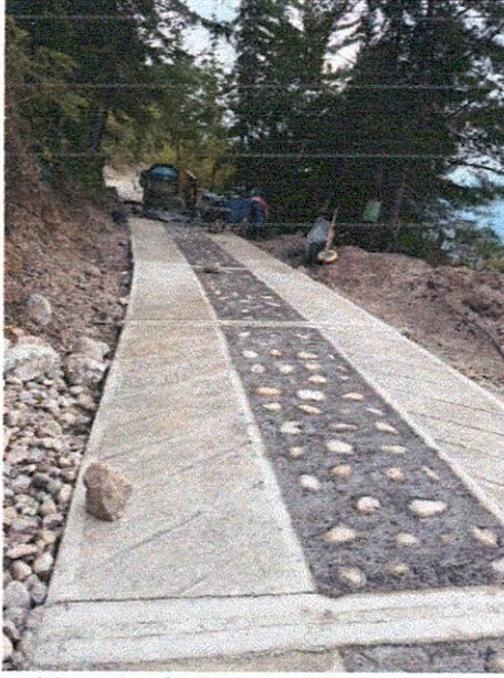
Suministro e instalación de concreto de 3.000 psi para estructuras de placa huella
