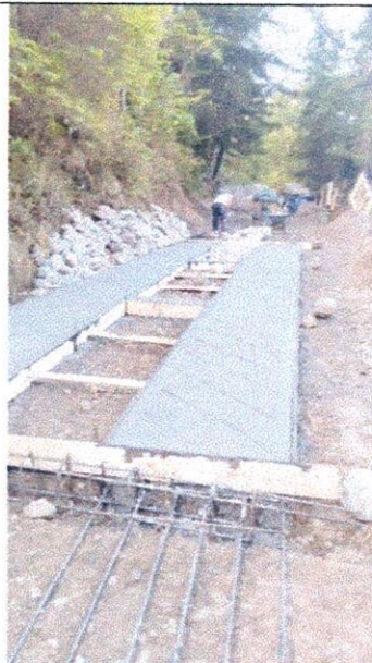
Suministro e instalación de concreto de 3.000 psi para estructuras de placa huella
