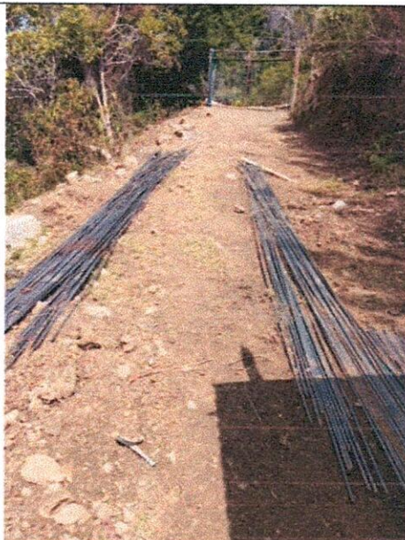
Suministro y figurado de acero de refuerzo de 4200 mpa para placas, vigas, cunetas y bordillos.
