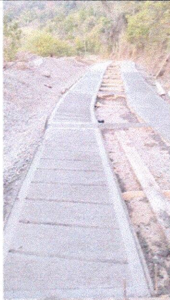
Suministro e instalación de concreto de 3.000 psi para estructuras de placa huella
