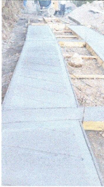
Suministro e instalación de concreto de 3.000 psi para estructuras de placa huella
