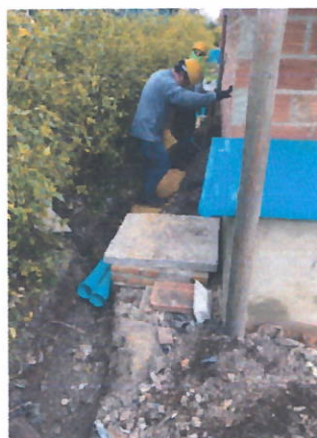
Fig. 13 ductos de 2 \phi 4" PVC Conduit para tableros de distribución
