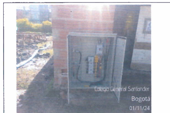
Fig. 16 Suministro e instalación de tablero de distribución general.
