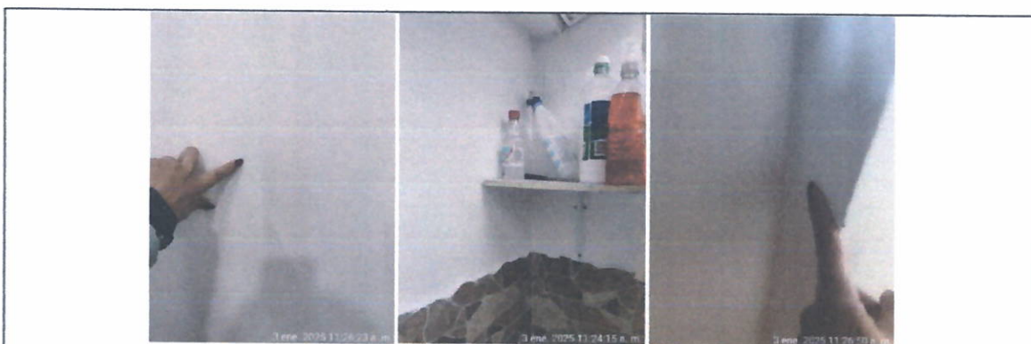
Foto 12, 13 y 14: Visita verificación fisuras PQRS No 6.
