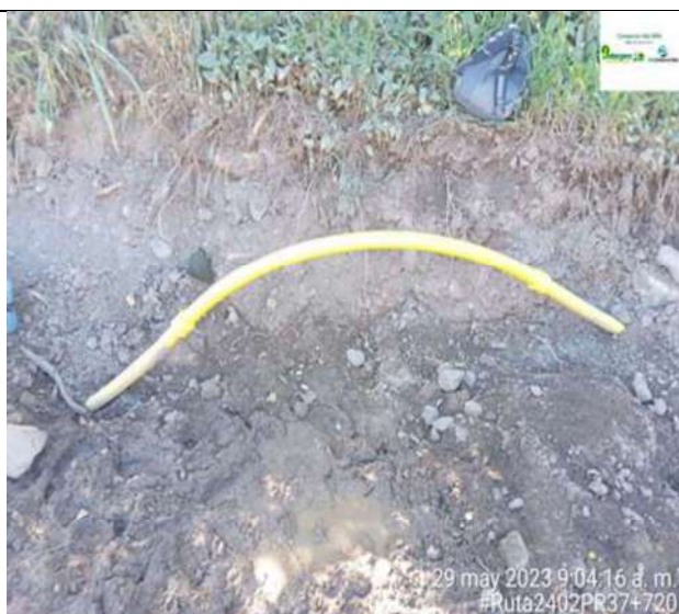
Foto 14: Reparación manguera de gas. Fecha: 29 de mayo de 2023 Lugar: Pr 37+720
