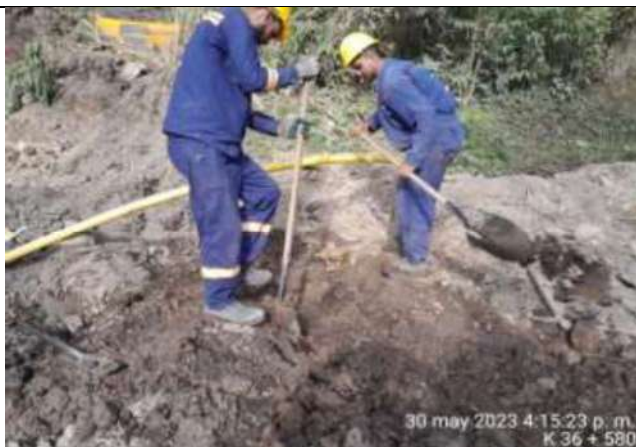
Foto 17: Afectación manguera de gas. Fecha: 30 de mayo de 2023 Lugar: Pr 36+580
