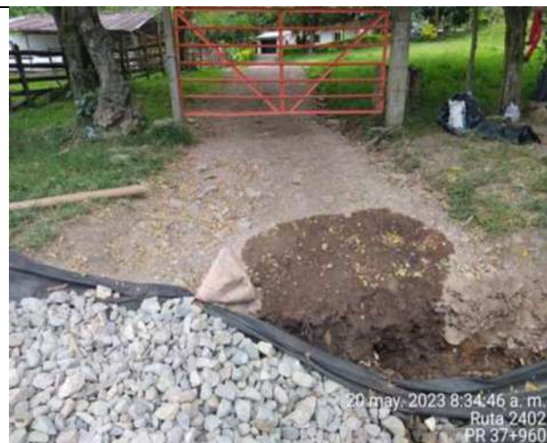
Foto 11: Afectación manguera de agua. Fecha: 20 de mayo de 2023 Lugar: Pr 37+960
