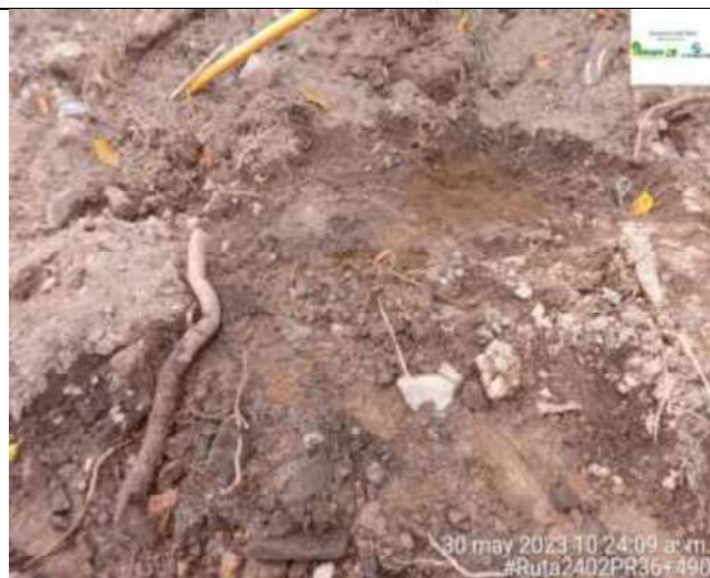
Foto 15: Afectación manguera de agua. Fecha: 30 de mayo de 2023 Lugar: Pr 36+490
