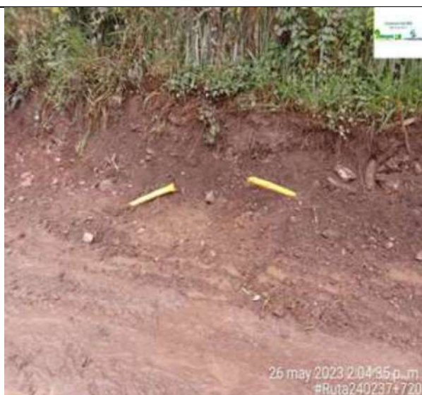
Foto 13: Afectación manguera de gas. Fecha: 26 de mayo de 2023 Lugar: Pr 37+720
