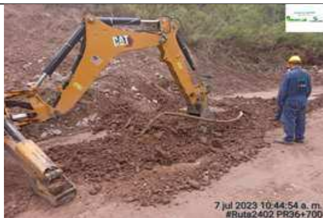
Foto 16: Afectación red de gas.
