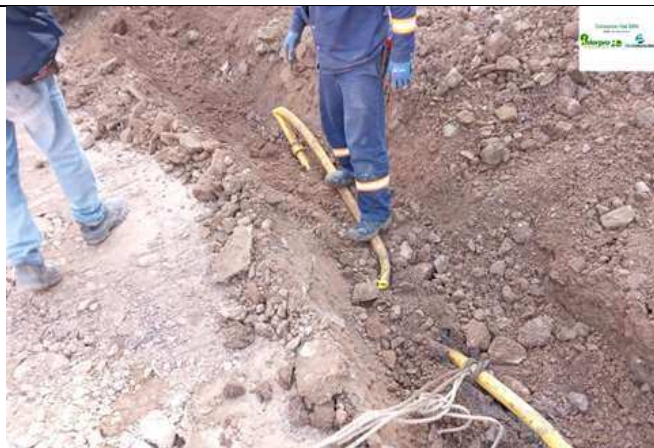
Foto 16: Afectación red de gas.
