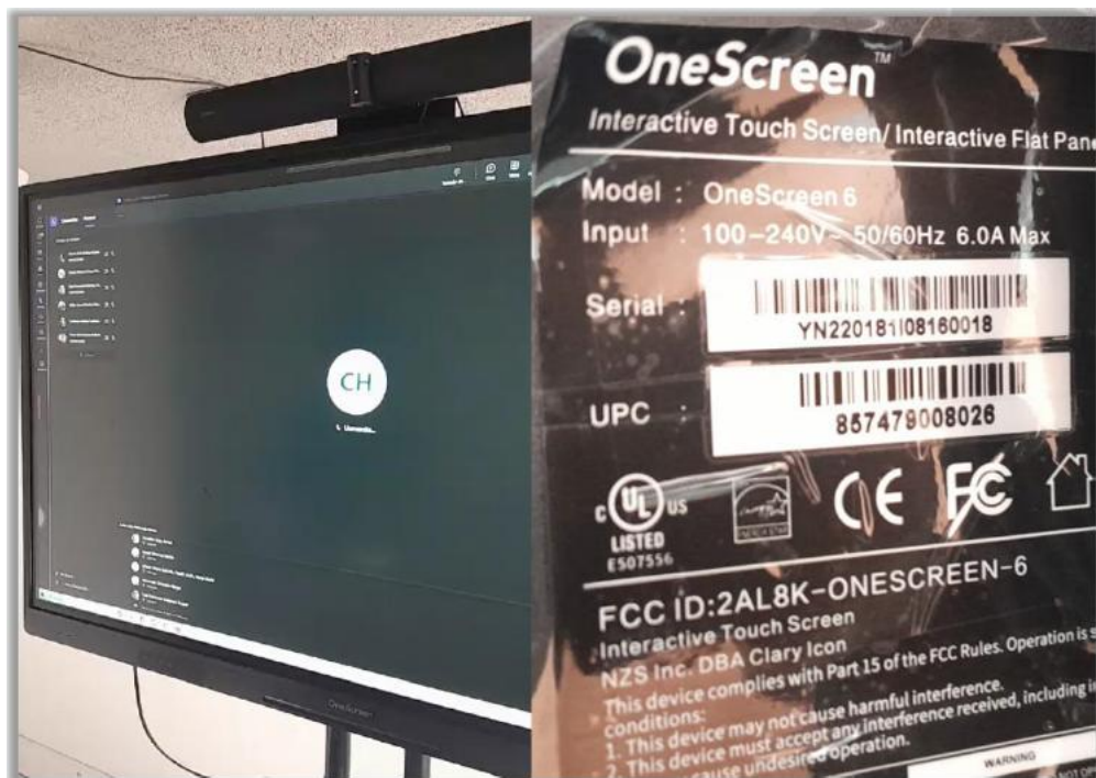
Ilustración 37 Evidencia módulo funcional sede aguas 65 – piso 4 – visita octubre 2024
