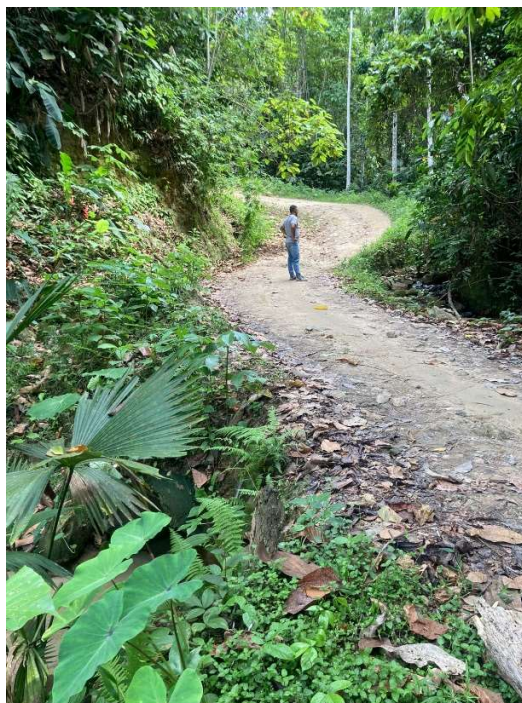
Imagen 4. Estado inicial tramo 1.
