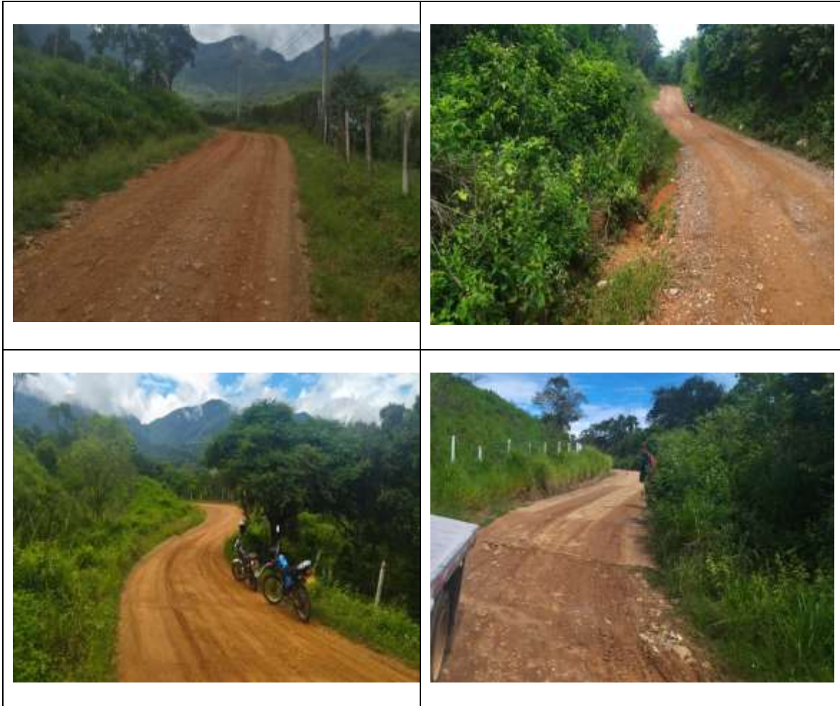
Fotografía 13 Estado actual del corredor vial a intervenir – Gobernación-2052- Los Patios
