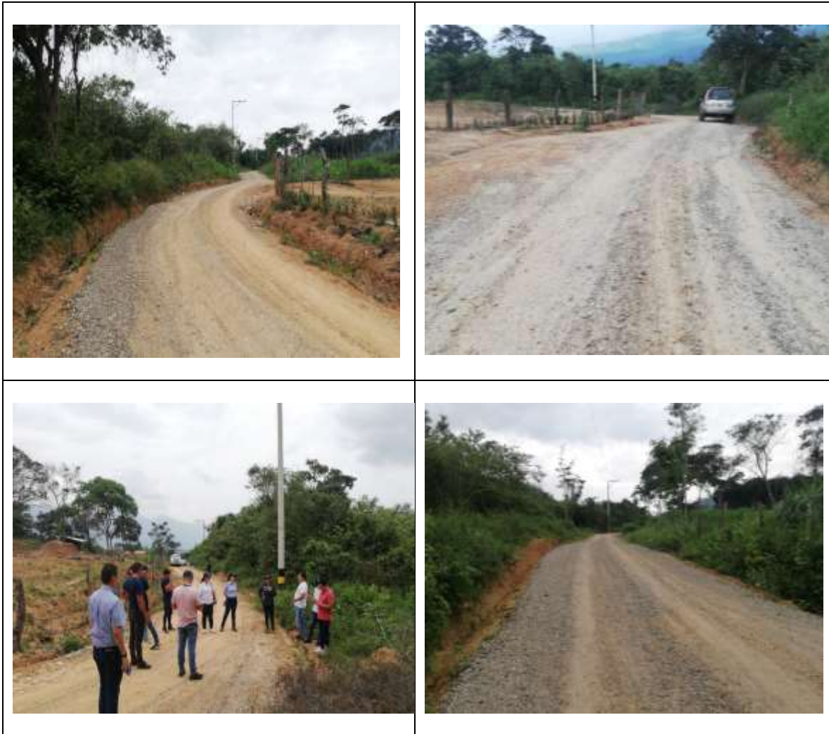
Fotografía 12 Estado actual del corredor vial a intervenir – Gobernación-1943- Los Patios
