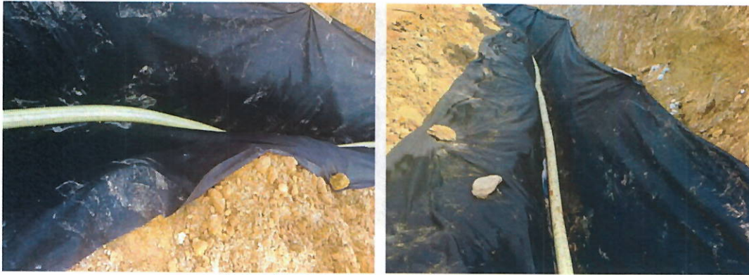
Ilustración 55 Tubería de drenaje en tramo 3
