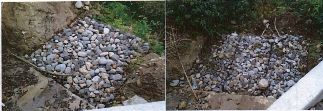
Ilustración 45 Gaviones en tramo 2
