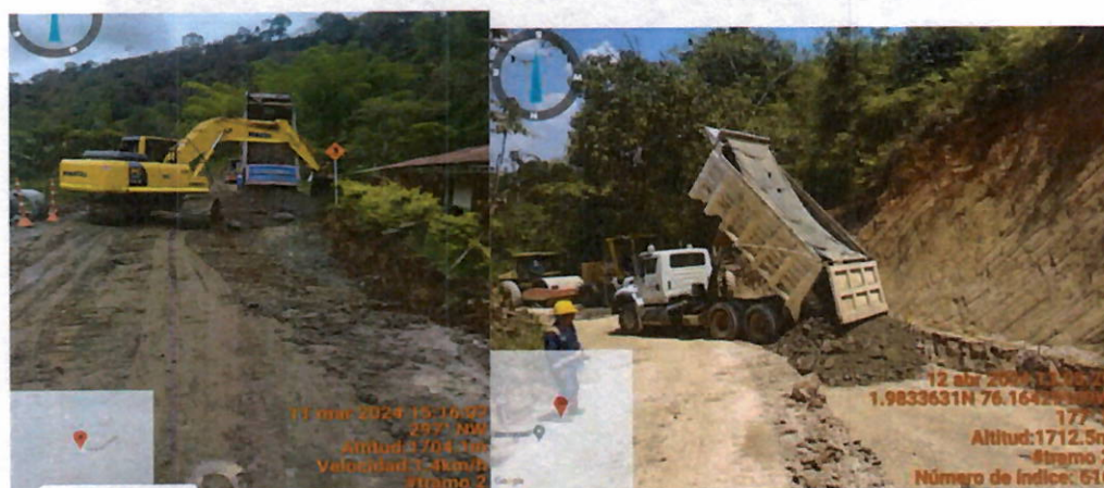
Ilustración 24 Transporte de material de mejoramiento en tramo 2
