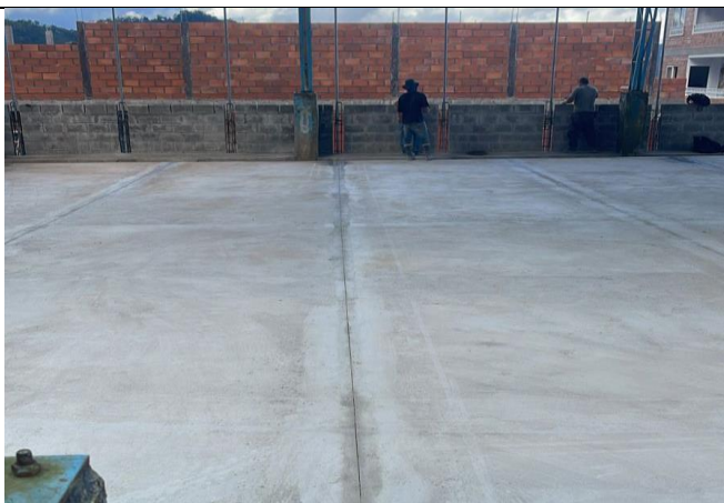
Fotografía 8 : Dilataciones de piso en concreto.
