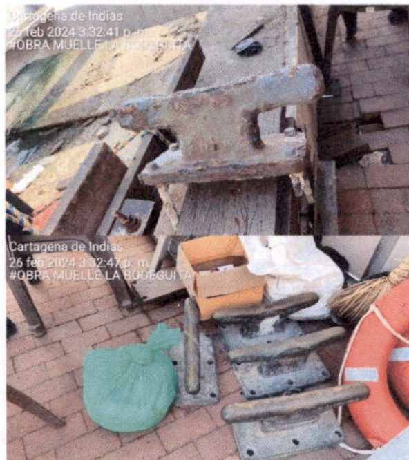
Ilustración 49. Bitas retiradas del muelle.
