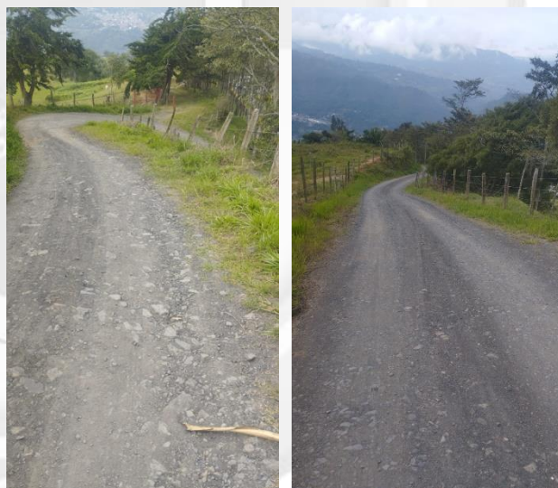
Imagen 2 – Zona a intervenir - Vía Que Conduce desde Escuela rural sede vereda resguardos a la Vda. Moyas Sector La recebera en el KM 1+640 y KM 0+870
