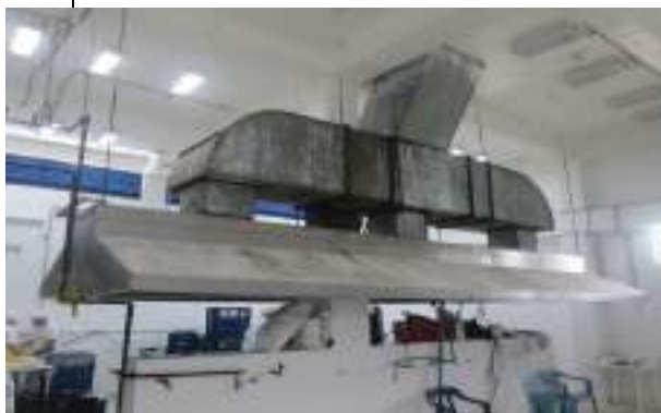
Ilustración 1: Estado de la campana extractora inicial
