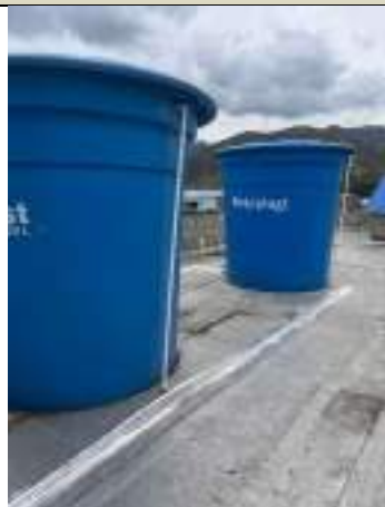
Ilustración 20: 12/12/2024 Revisión de conexiones hidráulicas en funcionamiento
