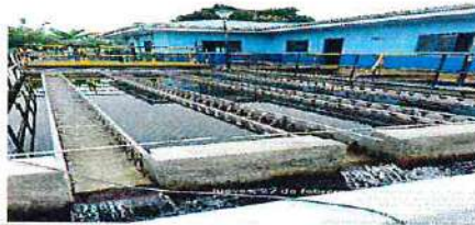
FOTOGRAFÍA No. 11: Sedimentador 3: En servicio
