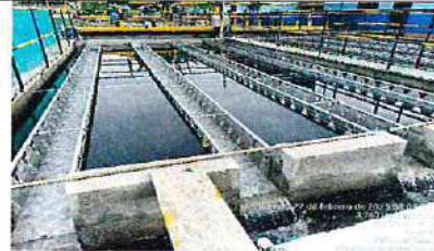
FOTOGRAFÍA No. 12: Sedimentador 2: En servicio
