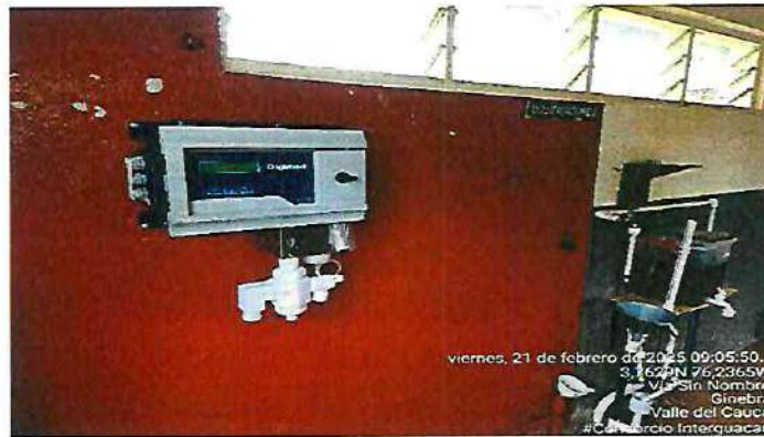
Faltan las conexiones eléctricas y de dosificación del coagulante
