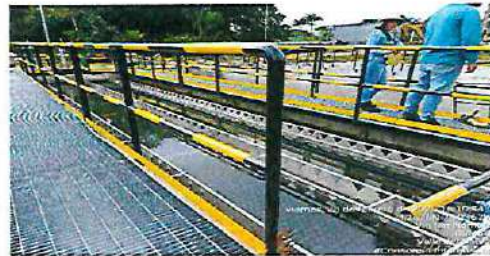
FOTOGRAFÍA No.2: Sedimentador 2 : En servicio
