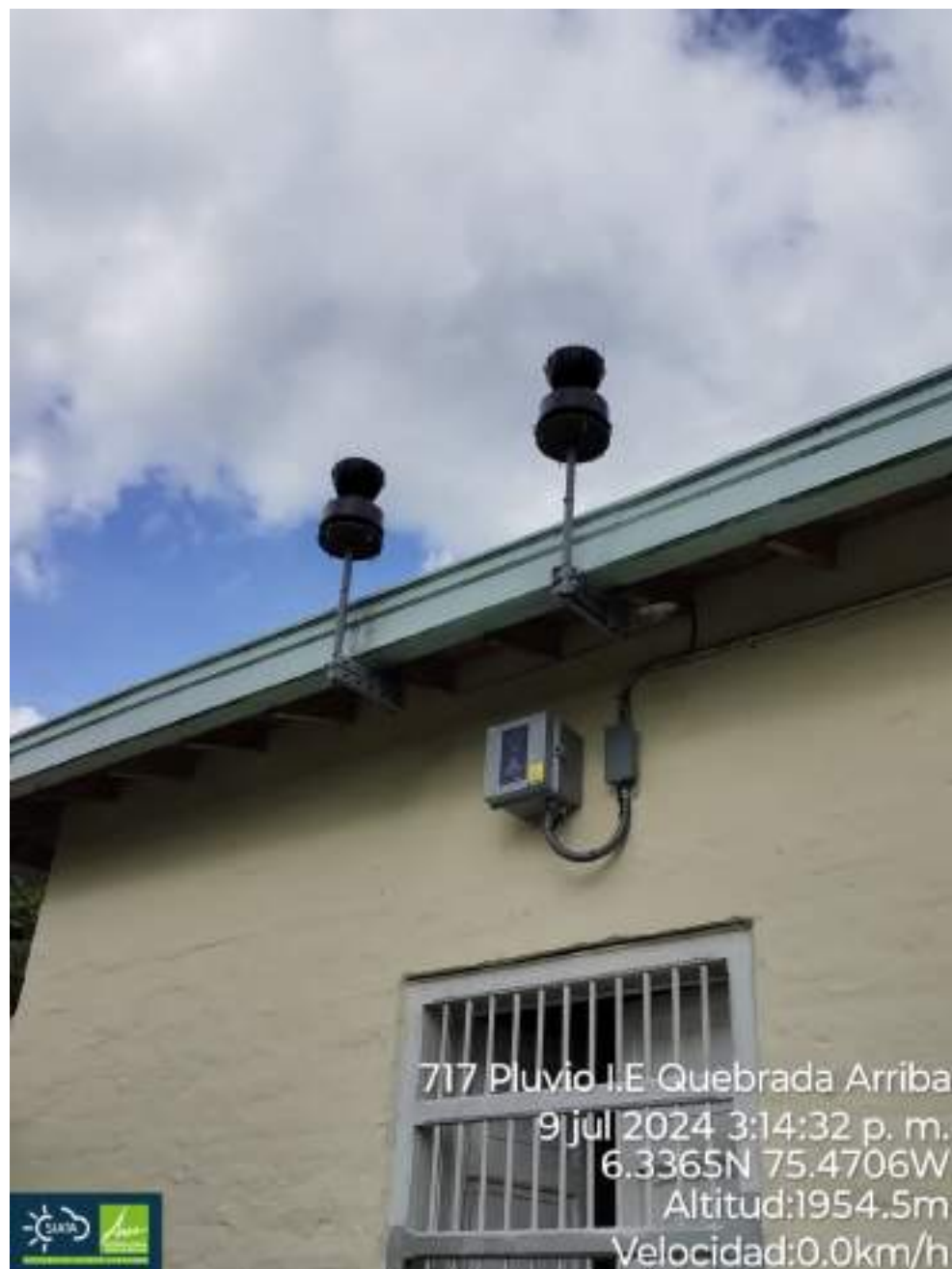
Figura 18.4: Pluviómetro I.E. Quebrada Arriba.
