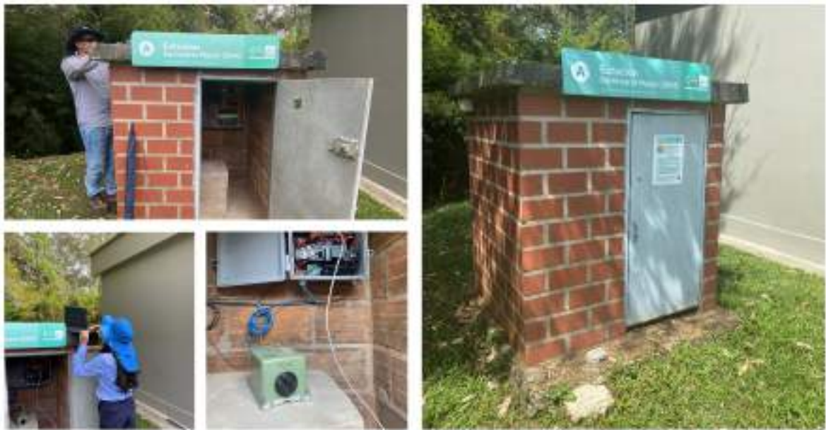
Figura 11.13: Jornada de instalación del sensor TITAN-SMA en la estación Seminario Mayor (SEM), llevada a cabo el 16 de julio de 2024.
