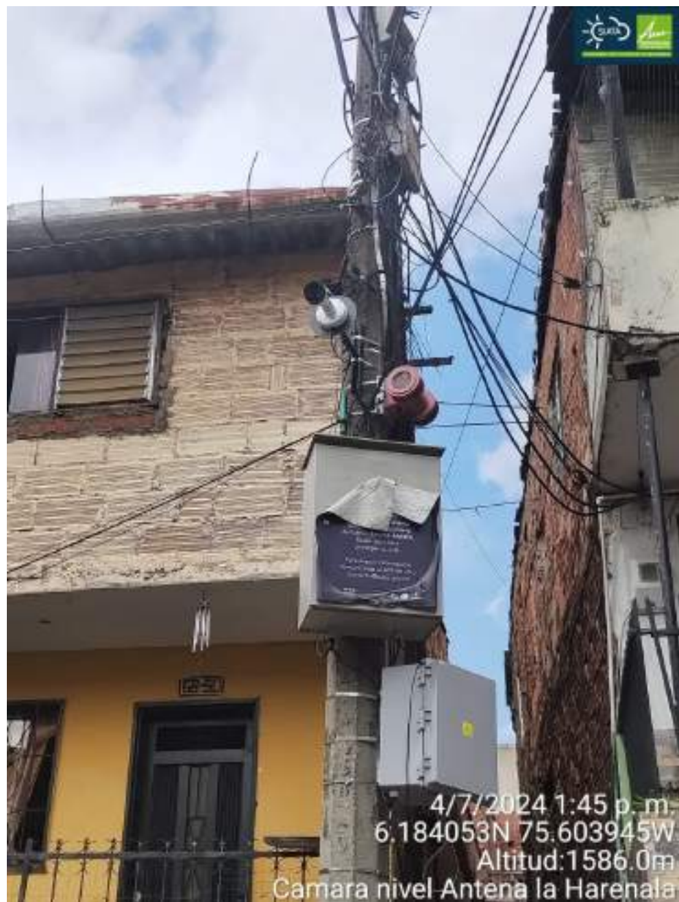
Figura 18.2: Cámara nivel La Harenala.
