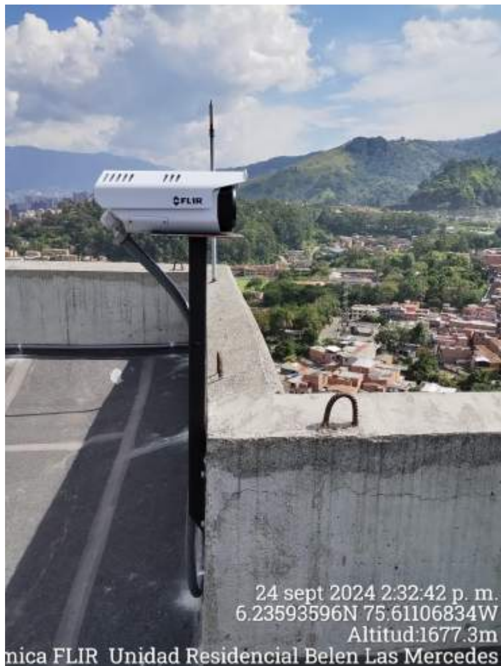
Figura 19.4: Cámara térmica instalada en el barrio Belén Las Mercedes.
