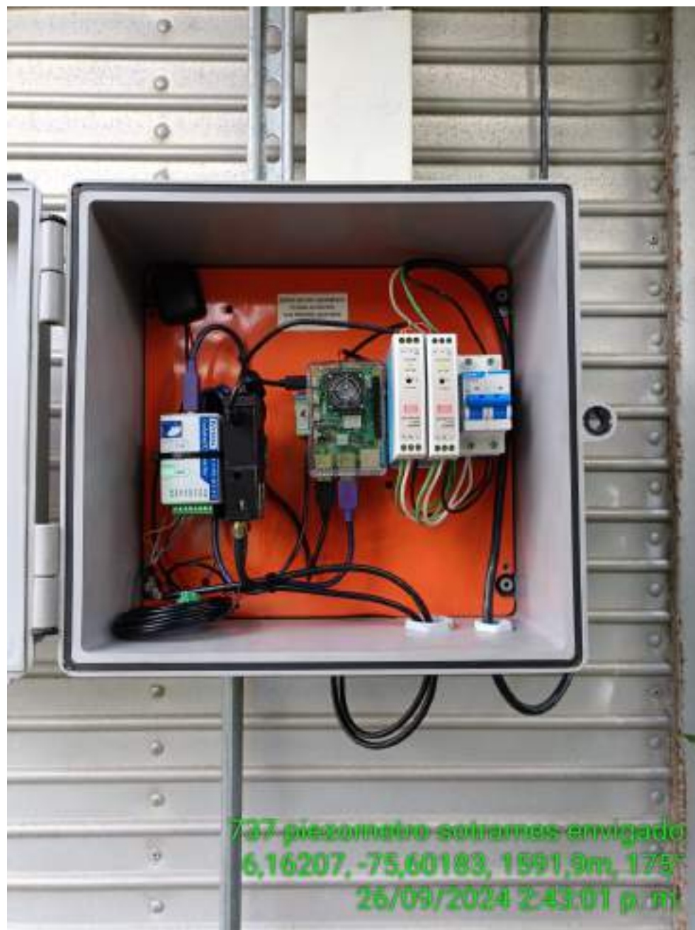
Figura 19.5: Piezómetro Sotrames, municipio de Envigado.
