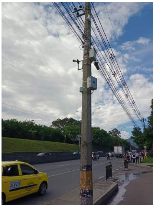
Figura 8.4: Equipo Armadillo instalado en las inmediaciones de la Fiscalía General de la Nación - Sede Caribe.
