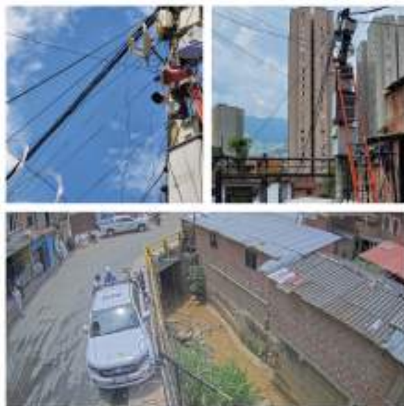
Figura 14.6: Instalación cámara SATC Hato Viejo.
