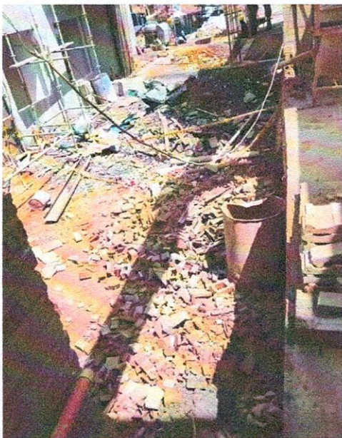
Foto No. 12 Acopio inadecuado de residuos de demolición
