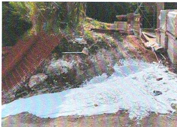
Foto No. 34 Disposición inadecuada de residuos de construcción
