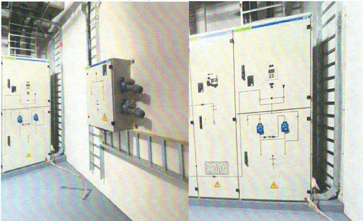
2 Imagen de gabinete de salida y llegada a transferencia ups
