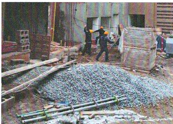
Foto No. 33 Acopio inadecuado de materiales pétreos
