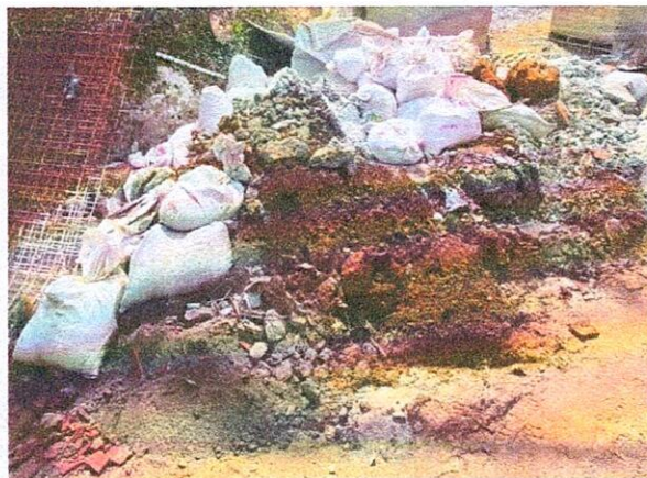
Foto No. 9 Acopio inadecuado de residuos de demolición
