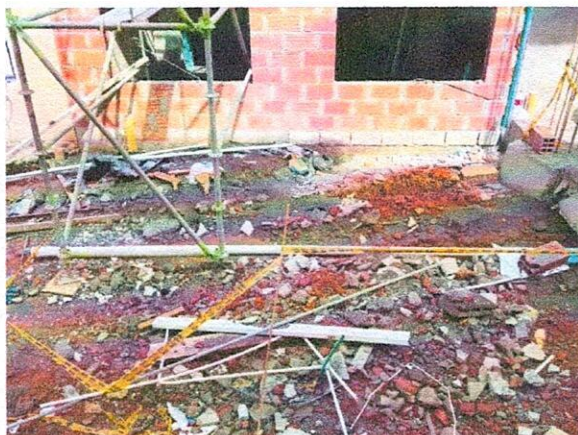
Foto No. 8 Acopio inadecuado de residuos de demolición
