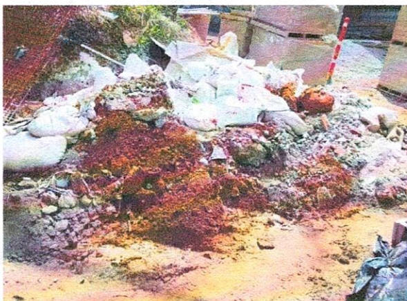
Foto No. 6 Acopio inadecuado de residuos de demolición
