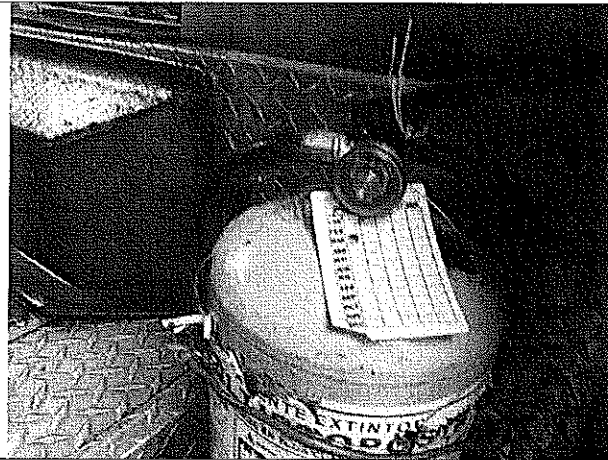
Inspección de extintor
