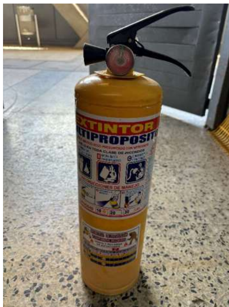
Ilustración 3. Inspecciones de extintores
