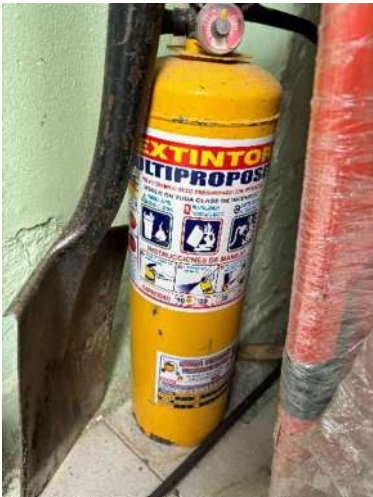
Ilustración 3. Inspecciones de extintores
