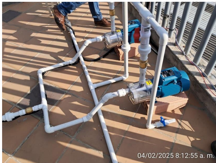
Foto 14. Equipos de bombeo instalados.
