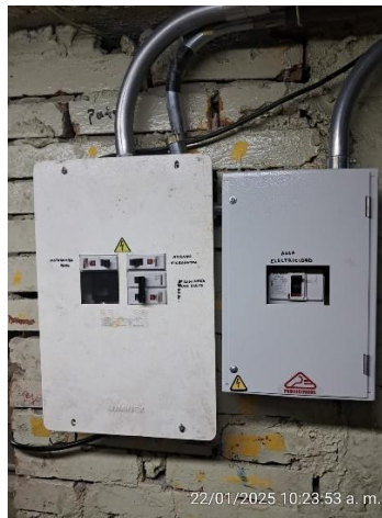
Foto 17. Tablero red existente.
