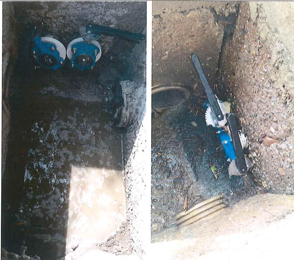
FOTOGRAFIA 23 Y 24: VALVULAS MARIPOSAS DE 3" PARA CONTROL DE LAVADO DE LOS DESARENADORES DE LAS UNIDADES DE PRETRATAMIENTO DE LA PTAR.
