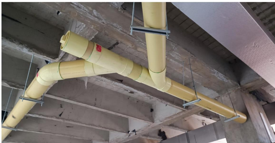
Imagen 10. Instalaciones hidrosanitarias, aire acondicionado, eléctricas Bloque 2
