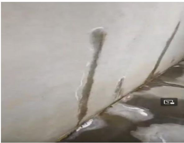
FILTRACIONES PISCINA RECREATIVA EN ZONA SUBTERRANEA
