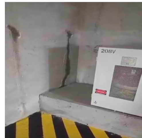
FILTRACIONES PISCINA RECREATIVA EN ZONA SUBTERRANEA
