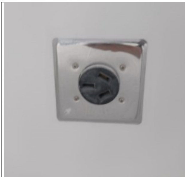
Foto N°10 TOMA 220V INSTALADO
