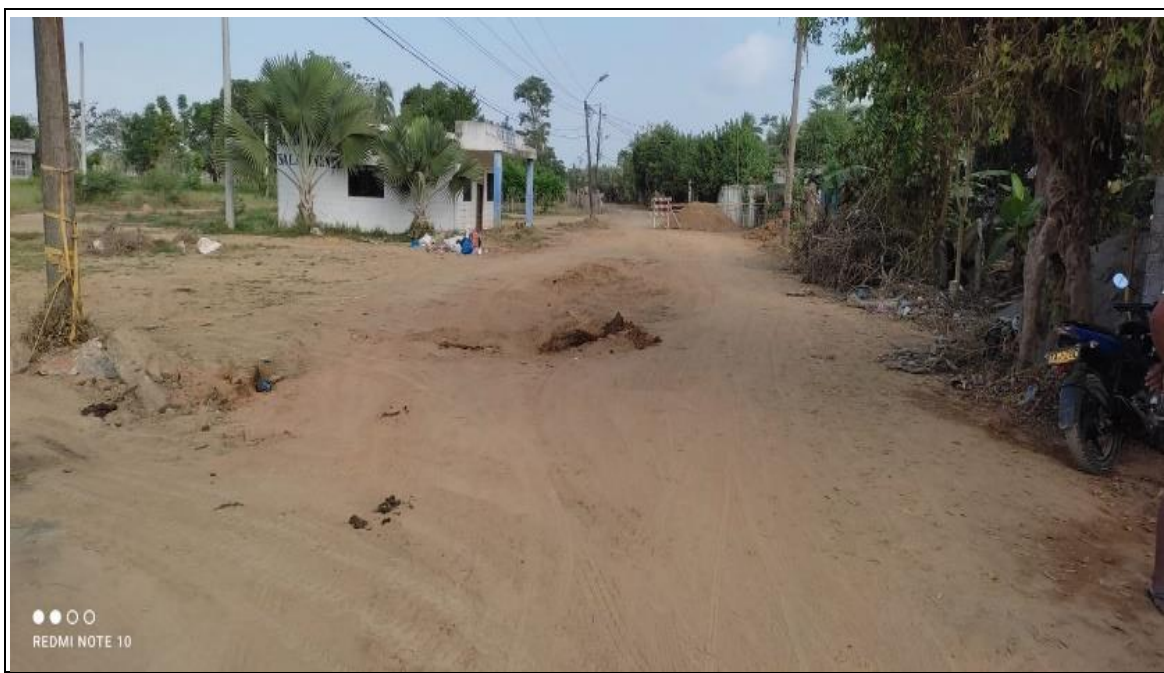
Vía en afirmado regular PR 0+000
