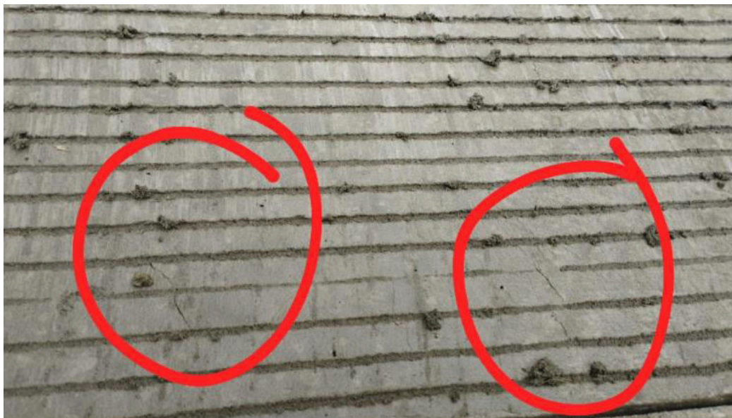
Imagen 3. Fisuras presentadas en losa del PR 1+420 LI
