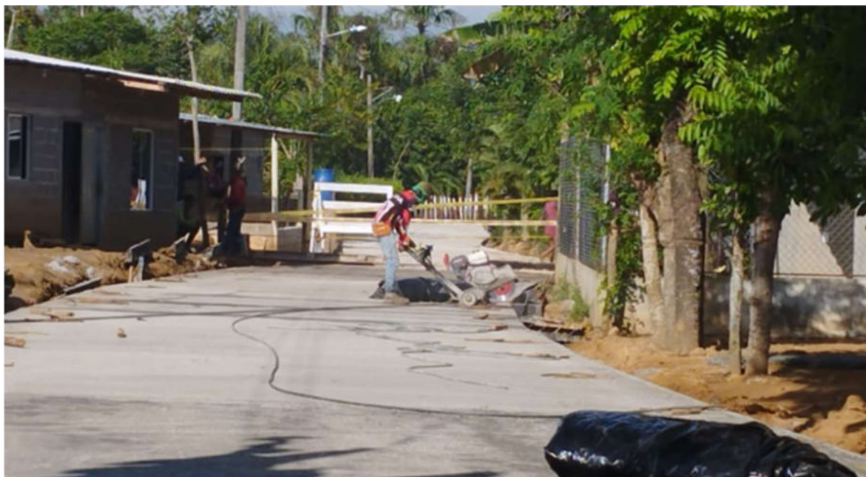
Foto 8. Corte de Juntas del PR 1+350 al PR 1+250 Chuchurubí.
