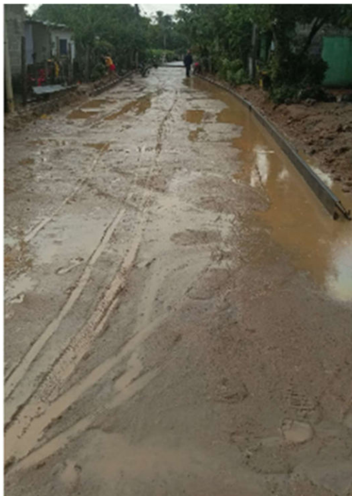
Foto 17. Daños por lluvias Chuchurubí.
