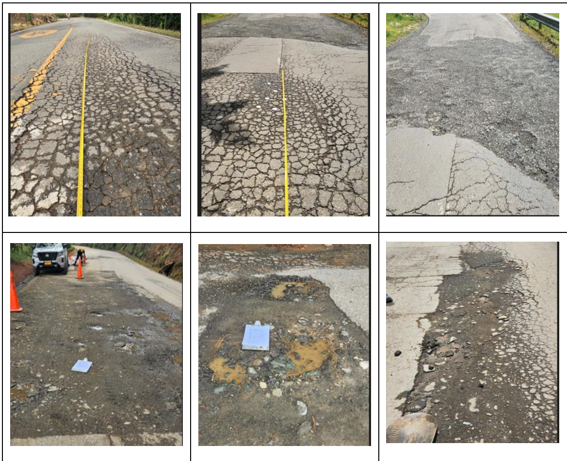
Ilustración 2 Patologías encontradas en sitio
