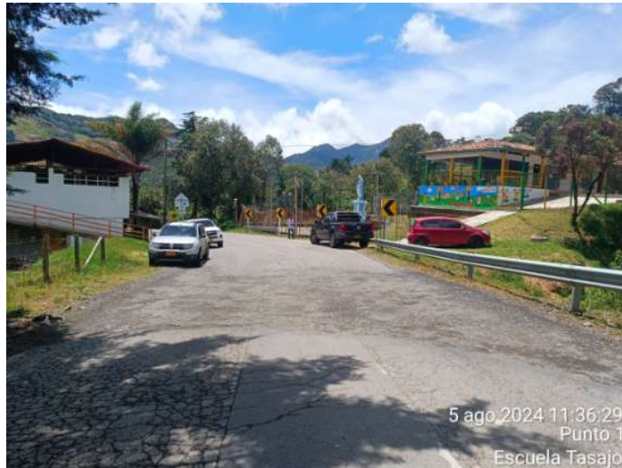
Deterioro y desgaste del pavimento flexible
