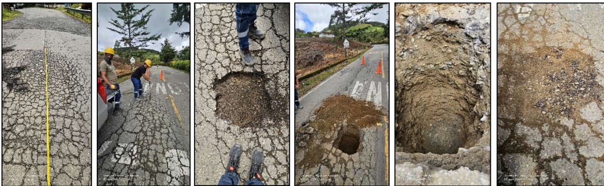
Ilustración 5. Apique No. 1 PR95+400, escuela Tasajo.
