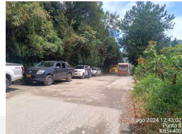
Baches, hundimientos, agrietamiento y piel de cocodrilo
