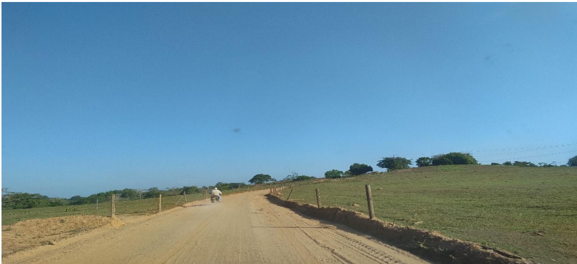
Base Granular afectada por el Tráfico Vehicular, que deberá ser reconformada y Cereada par la Imprimación.
