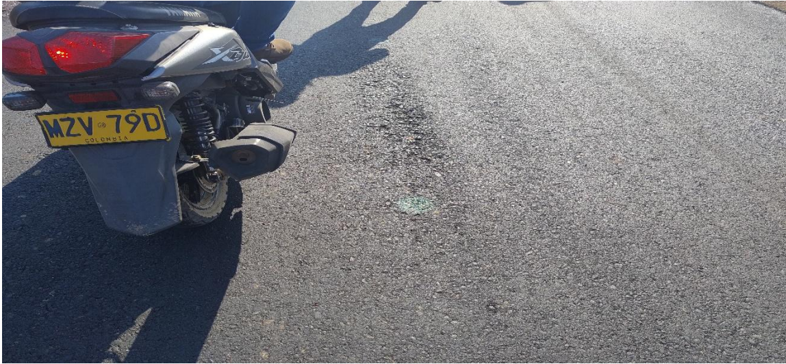
Segregación, muestra a la fecha desprendimiento de Material Pétreo.
