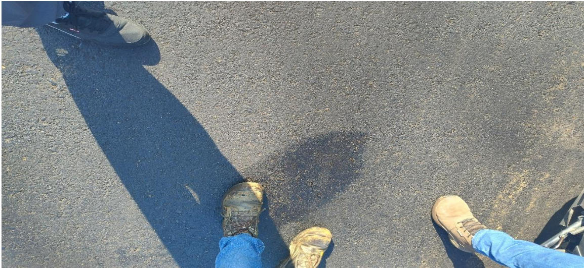
Derrame de Combustible, único responsable el Constructor, se ve afectada la Carpeta Asfáltica.
