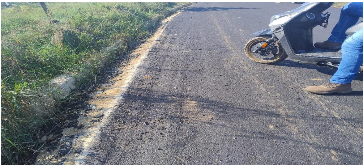
Hundimiento a revisar si es por humedad o mal proceso constructivo.
