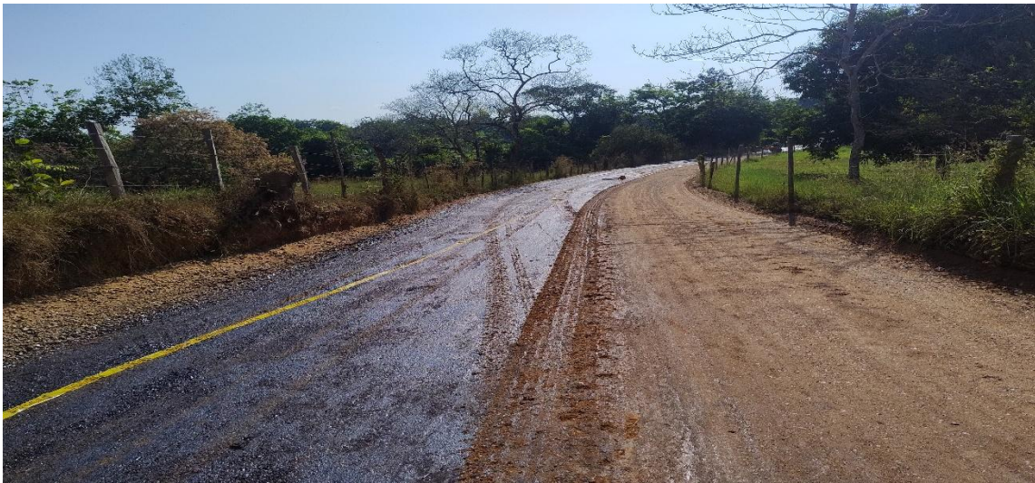
Imprimación de la Base Granular, se observa la baja penetración, lo que permite que el Asfalto Residual, se levante con el paso de los vehículos que por allí circulan.
