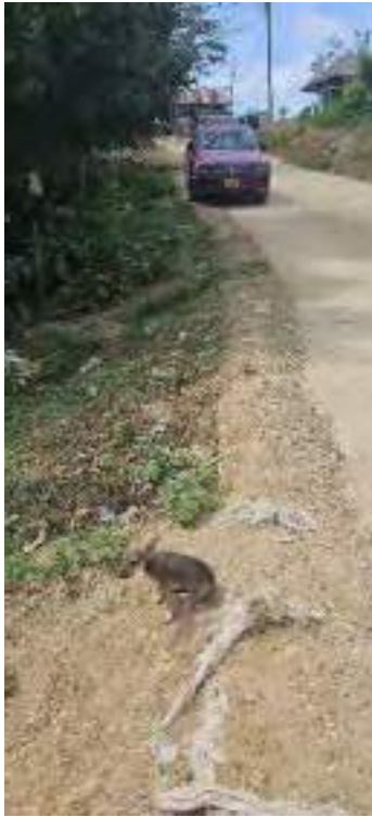
Vista estado placa huella construida, sitio falta construir anden a la altura del PR0+380
