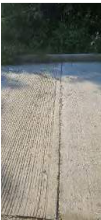
Vista desportillamientos en junta transversal
