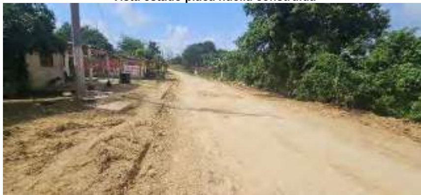
Vista estado subbase granular con presencia de acolchonamientos PR0+400
