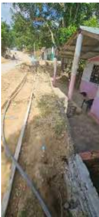
Vista estado andén a la altura del PR0+120
