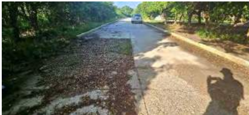
Vista inicio tramo PR0, se encuentra pendiente la construcción de una losa para el manejo del agua de escorrentía
