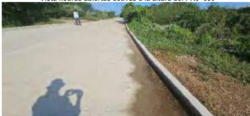
Vista losa fisurada a la altura del PR0+650
