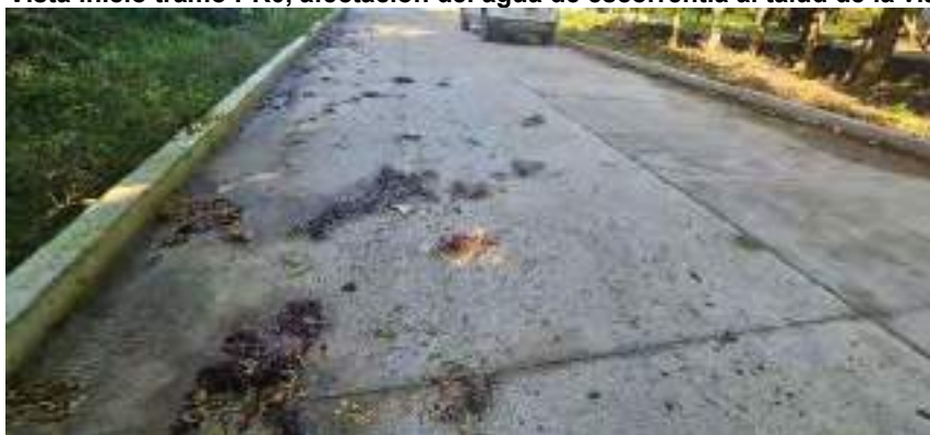
Vista losa con pérdida de la macrotextura, la cual se debe recuperar
