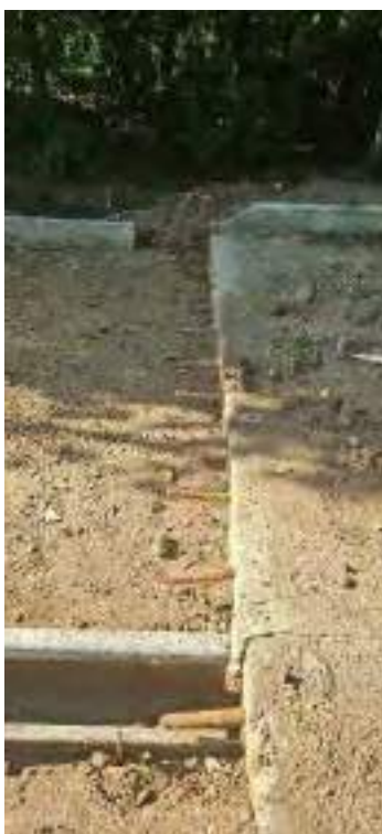
Vista barras de transferencias desalineadas a la altura del PR0+160
