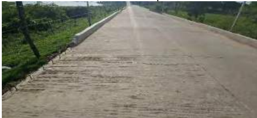
Vista fisura losa carril izquierdo pavimento rígido
