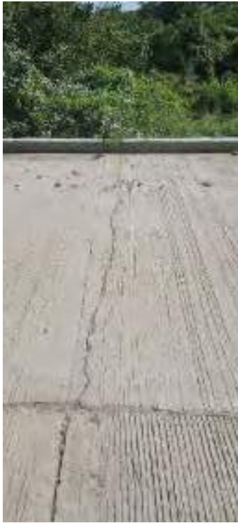
Vista losa fisurada a la altura del PR0+660
