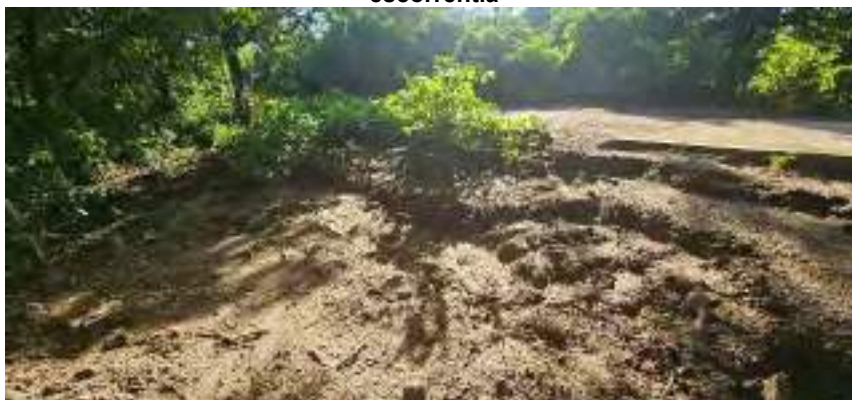
Vista inicio tramo PR0, afectación del agua de escorrentía al talud de la vía
