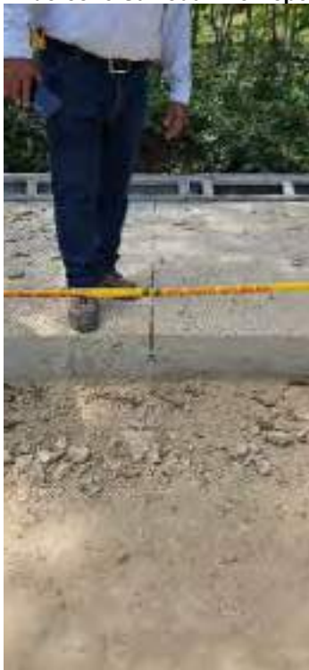
Vista inadecuada instalación de barras de amarre en el carril derecho San Juan De Nepomuceno – San Agustín
