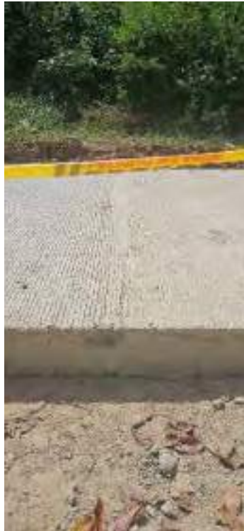
Vista fisura transversal carril derecho a la altura del K1+090 San Juan De Nepomuceno – San Agustín
