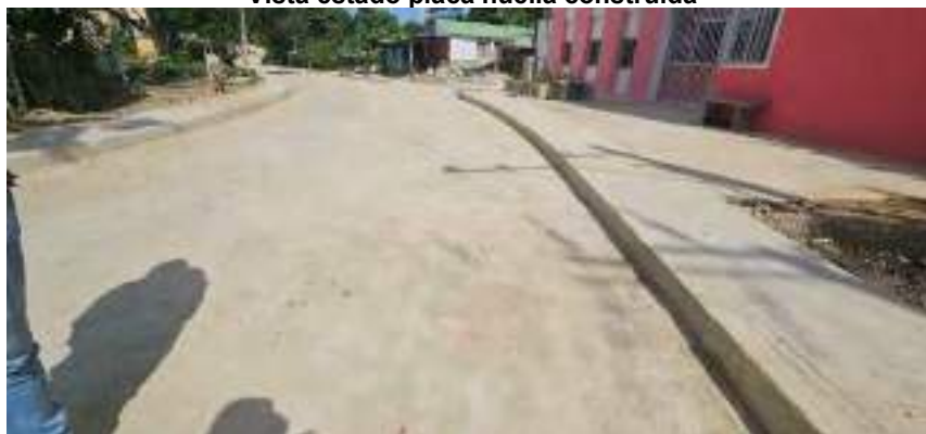
Vista residuos de concreto sobre placa huella construida
