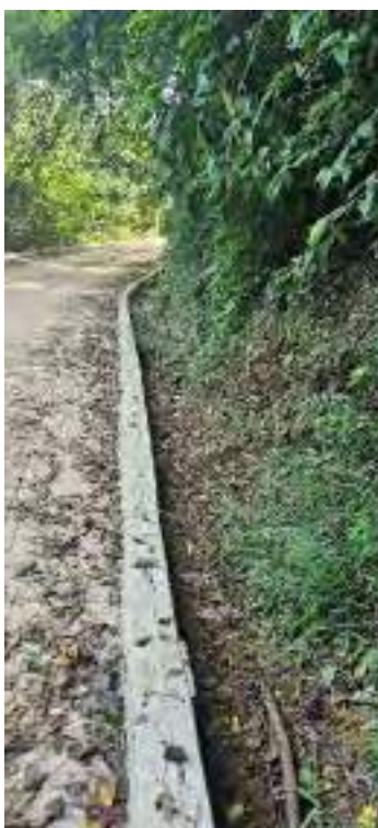
Vista falta del lleno por detrás de la cuneta
