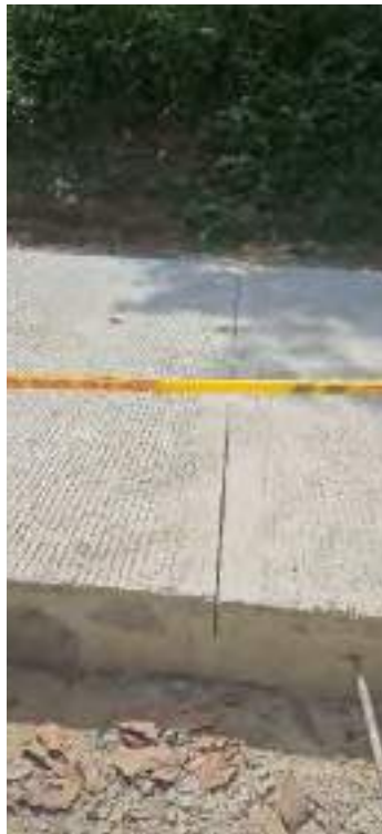
Vista fisura transversal carril derecho a la altura del K1+104 San Juan De Nepomuceno – San Agustín
