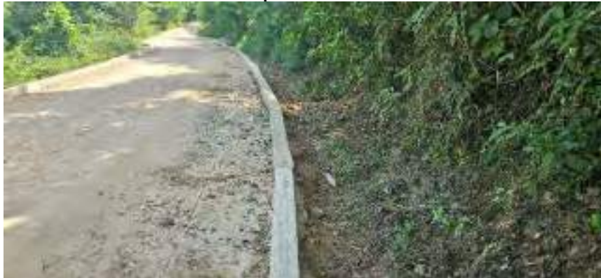
Vista falta del lleno por detrás de la cuneta
