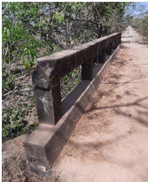
Fotografía 10. Puente 4, barandas con desportillamiento.
