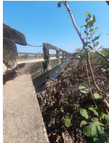
Fotografía 9. Puente 3 Corrosión en acero expuesto.
