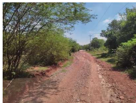
Fotografía 2 Estado actual de la vía. Contrato 241-2022
