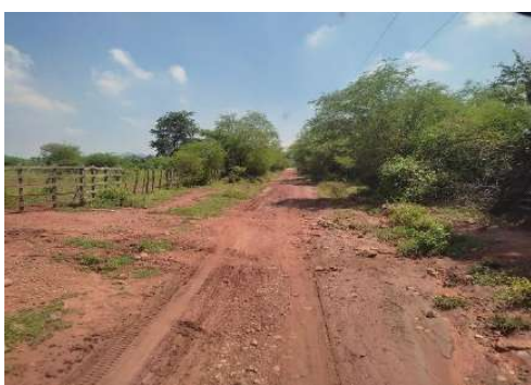
Fotografía 1 Estado actual de la vía. Contrato 241-2022
