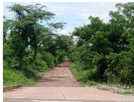
Fotografía 2 Estado actual de la vía. Contrato 104-2022
