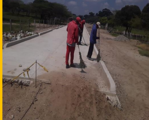
Trabajadores sin EPP
