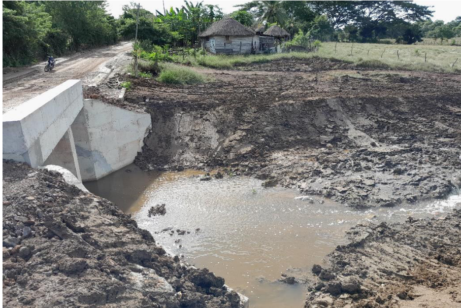
Fotografía N° 25. Descoles en Box culvert en Km 13+346.
