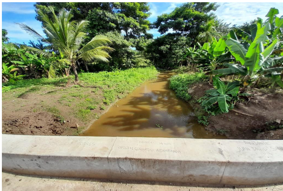
Fotografía N° 24. Descoles en Box culvert en Km 13+346.
