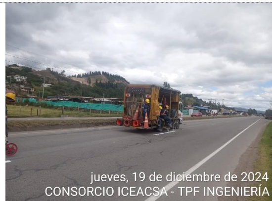
Ruta 45 A 04, PR33+0654 – PR38+0375 línea blanca de eje (19/12/24)
