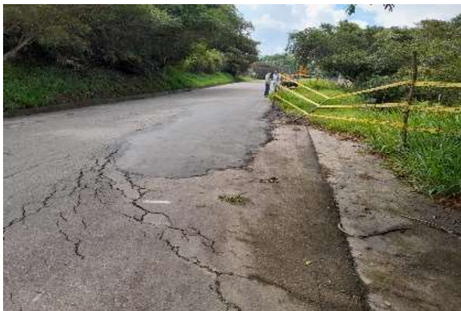
Fotografía 11: Se presenta hundimiento de calzada en carril derecho PR 23+500.
