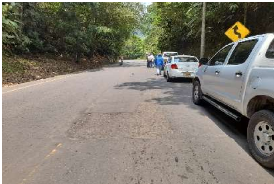
Fotografía 40: Tramo transitable, la vía presenta desgaste, ondulaciones, deflexiones, algunos baches. En esta zona si se prioriza para intervención se debe tener en cuenta que paralelo a la vía está instalado el tubo madre del acueducto del Municipio de Florencia PR 80+150 – PR 83+420.
