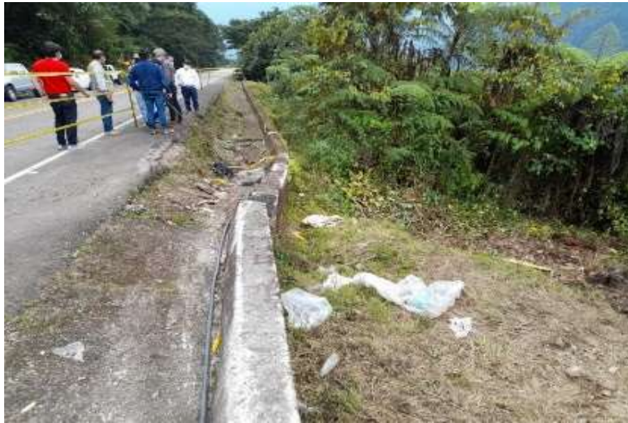
Fotografía 30: Se presenta hundimiento en la cuneta margen derecha, requiere estabilización PR 58+900.
