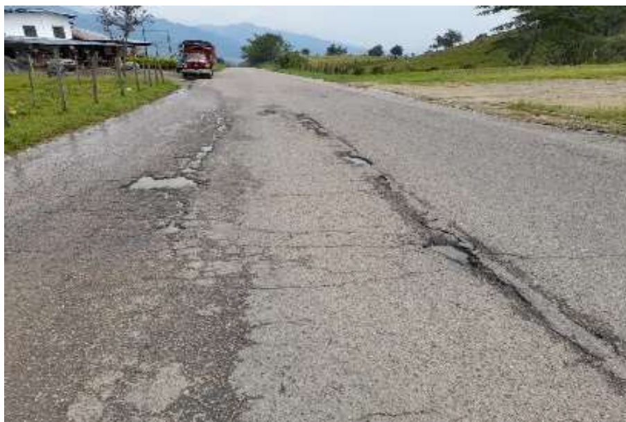
Fotografía 10: Carpeta en mal estado, presenta fisuras, baches, piel de cocodrilo, deflexiones PR 21+350 – PR 23+100
