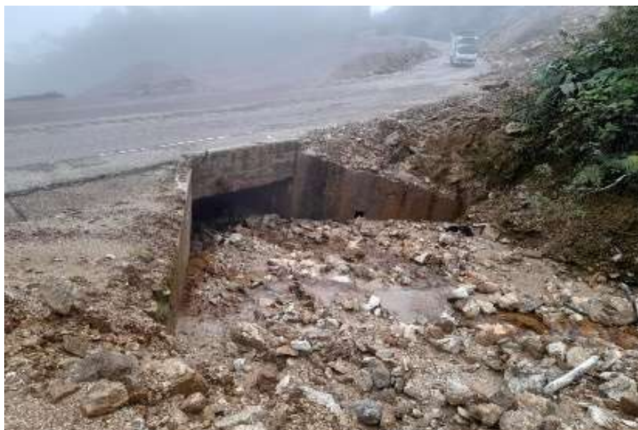
Fotografía 19: Obra de cruce (box culvert), presenta taponamiento por material de derrumbe de talud superior PR 44+200.
