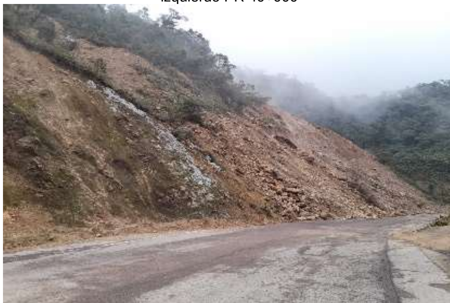
Fotografía 17: Sitio crítico; derrumbe talud superior, calzada con deficiencia para el tránsito PR 42+800 – PR 43+000
