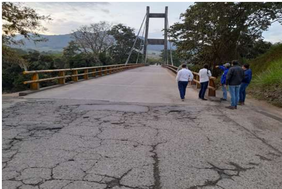
Fotografía 8: Puente el Avispero (Río Suaza), deficiencia en juntas y carpeta de rodadura PR 20+000
