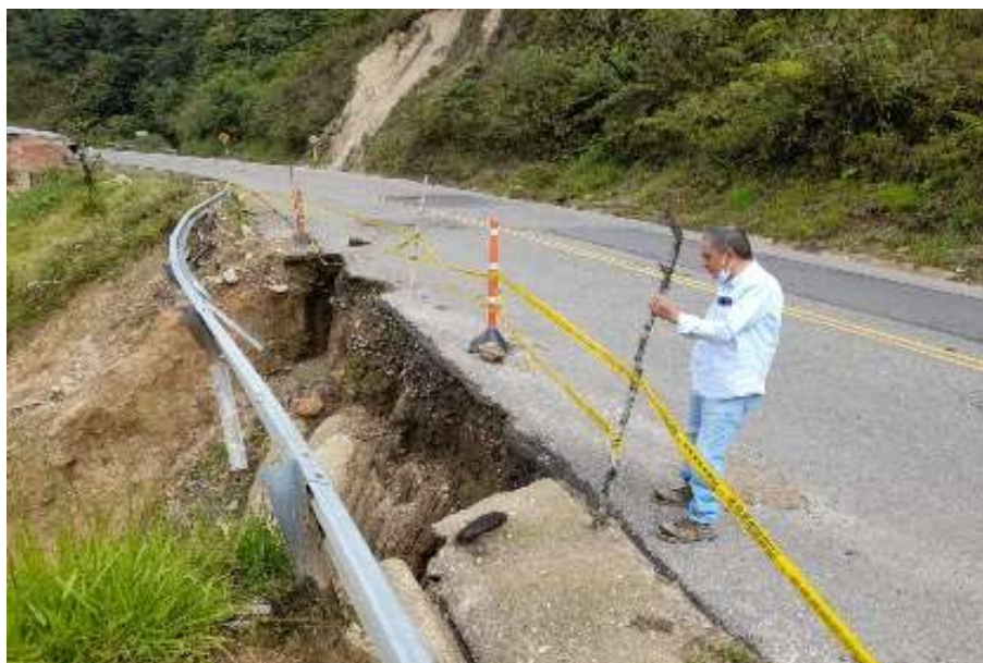
Fotografía 13: Se presenta pérdida de banca inferior carril derecho PR 35+400
