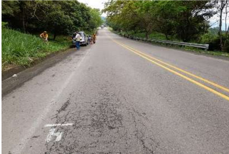
Fotografía 6: Presenta baches, mejoramiento de señalización, terraplén PR8+200 – PR 10+900 Y PR 12+000, puente Quebrada Seca PR 10+200; PR 7+500 – PR 14+000.
