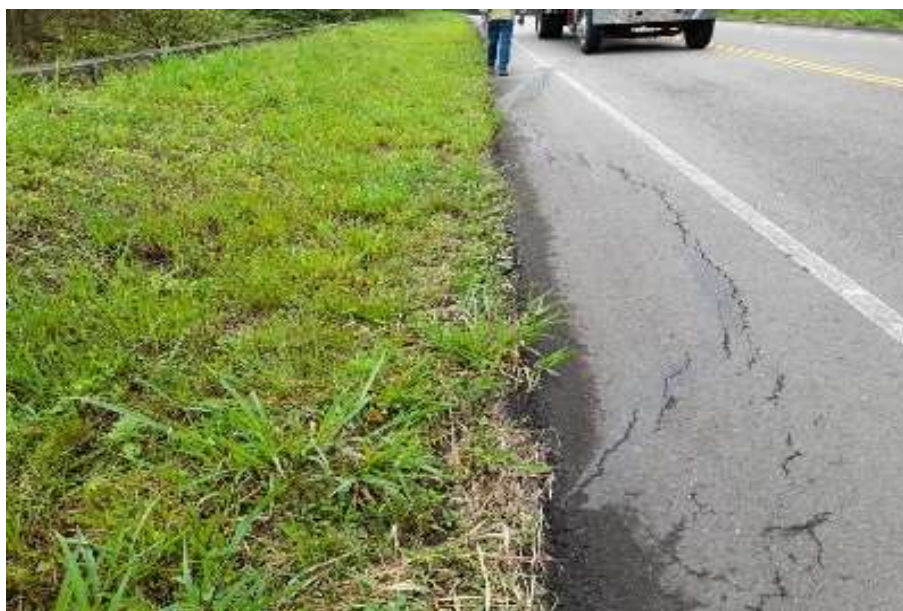
Fotografía 1: Hundimiento en la calzada PR 2+100 – 2+150 RUTA 2003
