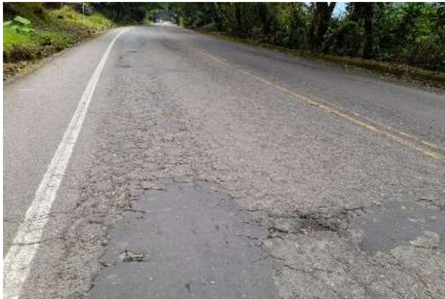
Fotografía 38: Carpeta asfáltica en mal estado, presenta desgaste, baches, fisuras, piel de cocodrilo PR 75+800 – PR 76+000.
