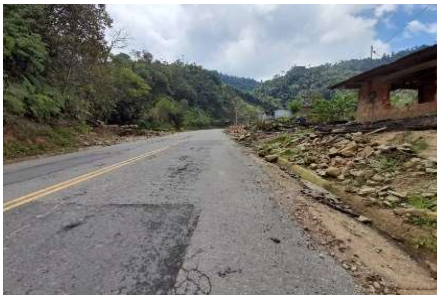
Fotografía 12: Carpeta asfáltica en mal estado, presenta tramos con parcheo localizado, falta reforzar señalización horizontal y vertical, piel de cocodrilo PR 30+400 – PR 35+000
