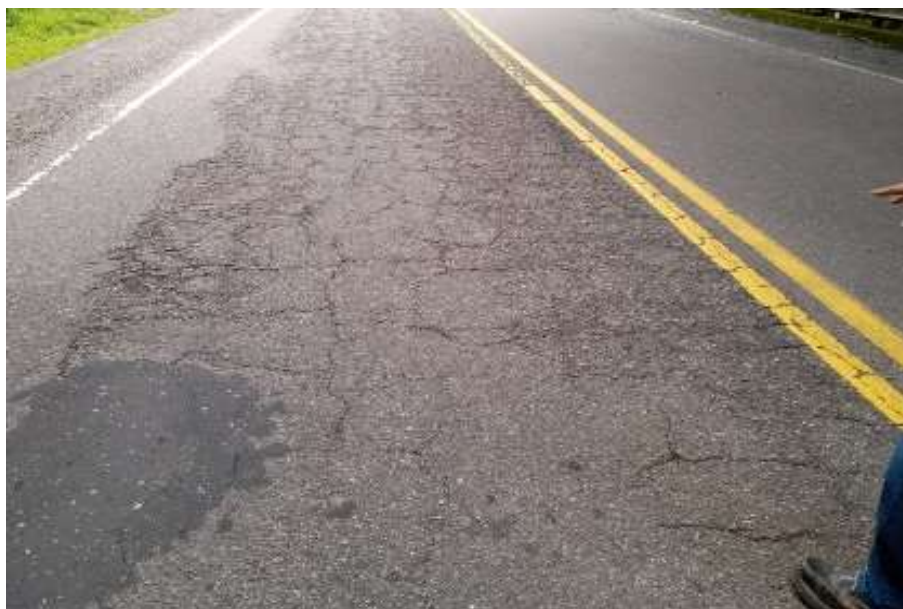
Fotografía 34: Tramo en regular estado, carpeta asfáltica presenta desgaste, baches, fisuras, deflexiones, ondulaciones PR 66+900 – PR 68+000.
