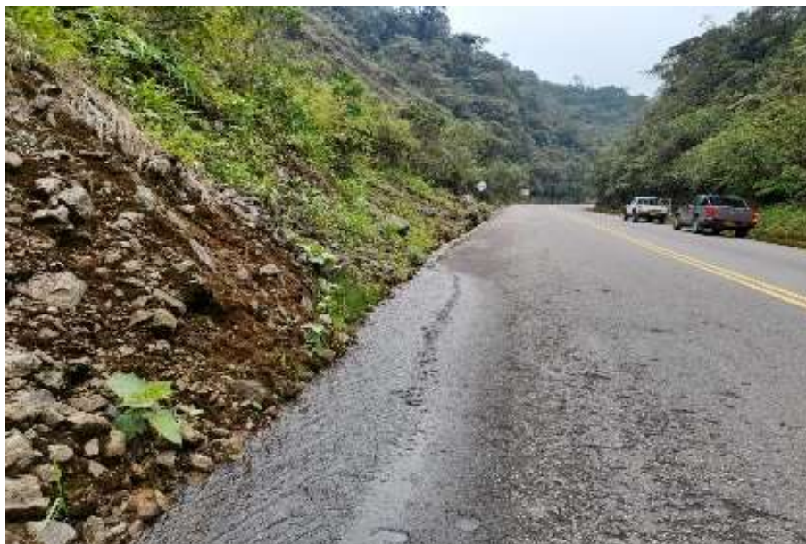
Fotografía 16: Presenta derrumbe talud superior y destrucción de bordillo cuneta carril izquierdo PR 40+000
