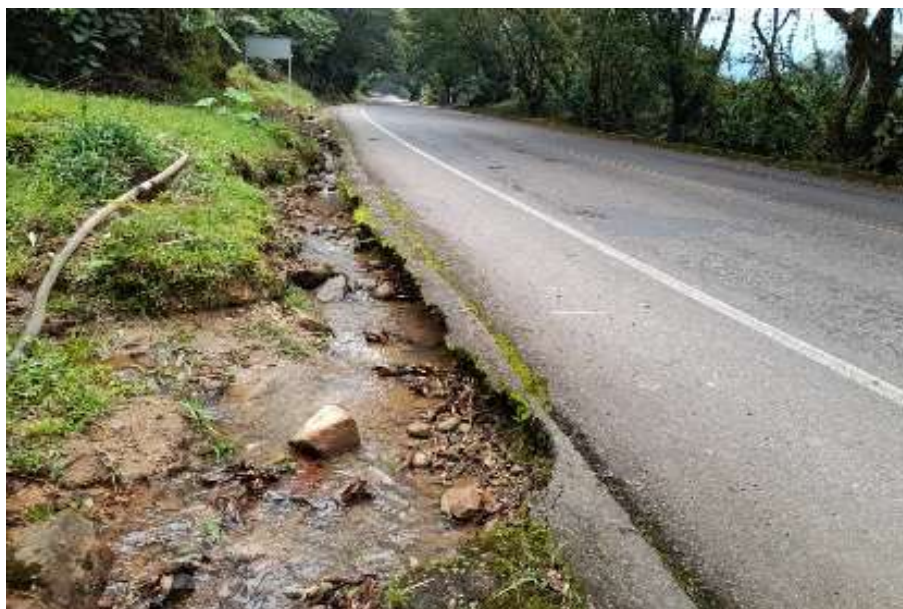
Fotografía 36: Presenta parcheo localizado en mal estado, falta tramo de cuneta margen derecha PR 71+700 – PR 72+000.
