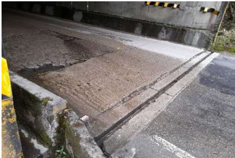
Fotografía 24: Túnel No. 2 (Long 425m) requiere juntas de dilatación portales de entrada y salida, reparar losa MR fracturada carril derecho PR 46+845 – PR 47+270.
