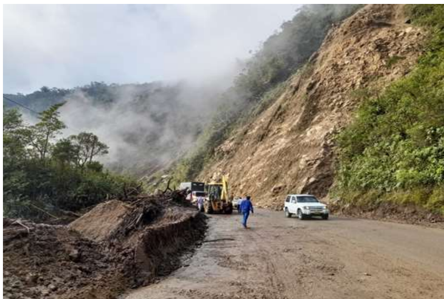
Fotografía 22: Sitio crítico; derrumbe talud superior, pérdida de señalización, obra de cruce saturada por material de derrumbe PR 45+100 – PR 45+200
