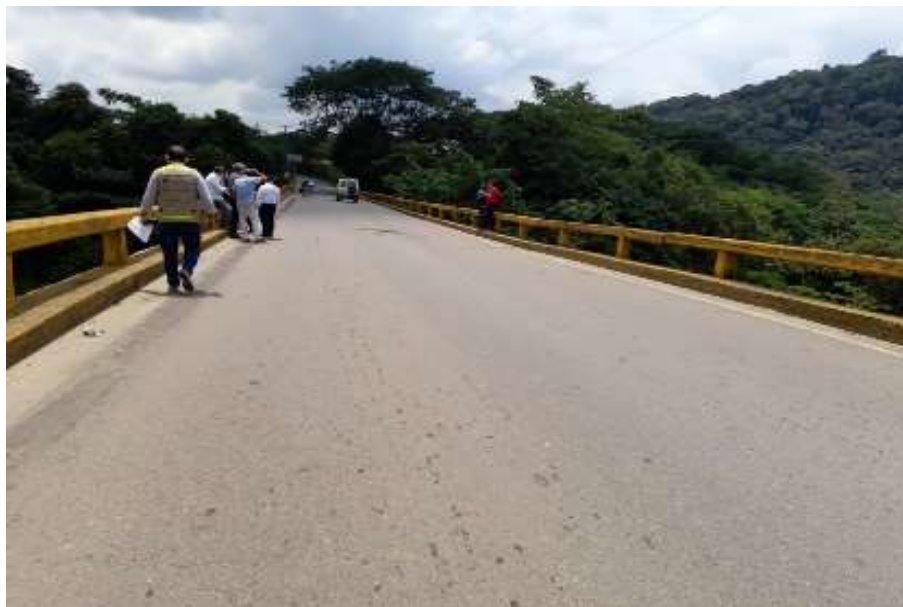
Fotografía 41: Puente Riohacha; se requiere reparar hueco existente en la losa del puente parte central de la losa de 1m de diámetro aprox) PR 83+420.
