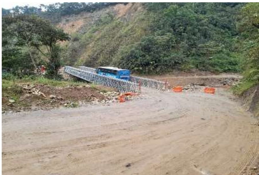
Fotografía 15: Zona de derrumbes, puente modular metálico. Se encuentra en intervención por contratos de emergencias PR 38+000 – PR 38+300
