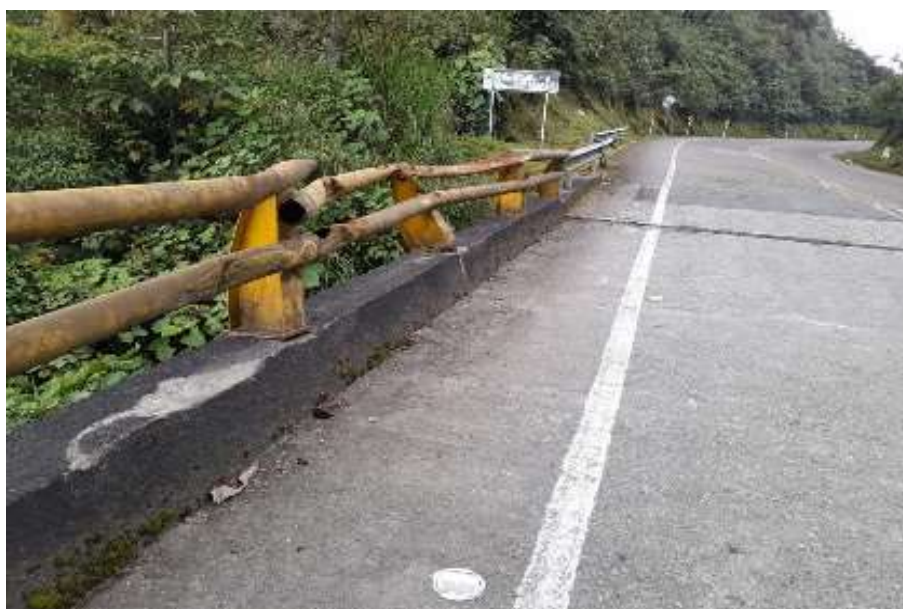
Fotografía 27: Puente Lasada; Juntas de dilatación entrada y baranda derecha en mal estado PR 49+020.
