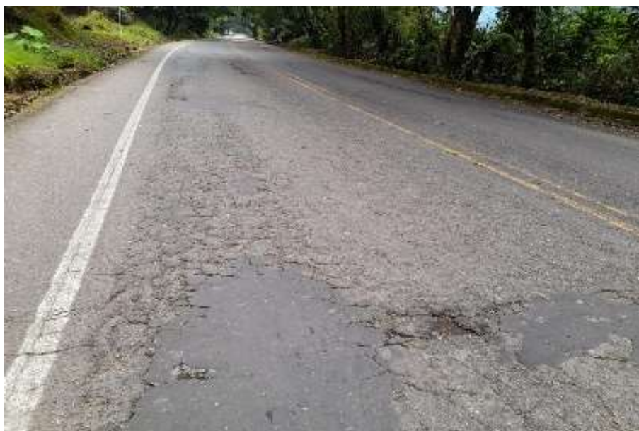
Fotografía 33: Tramo en mal estado, carpeta asfáltica presenta desgaste, baches, fisuras. Puente El Zanjón PR 66+400 – PR 66+600.
