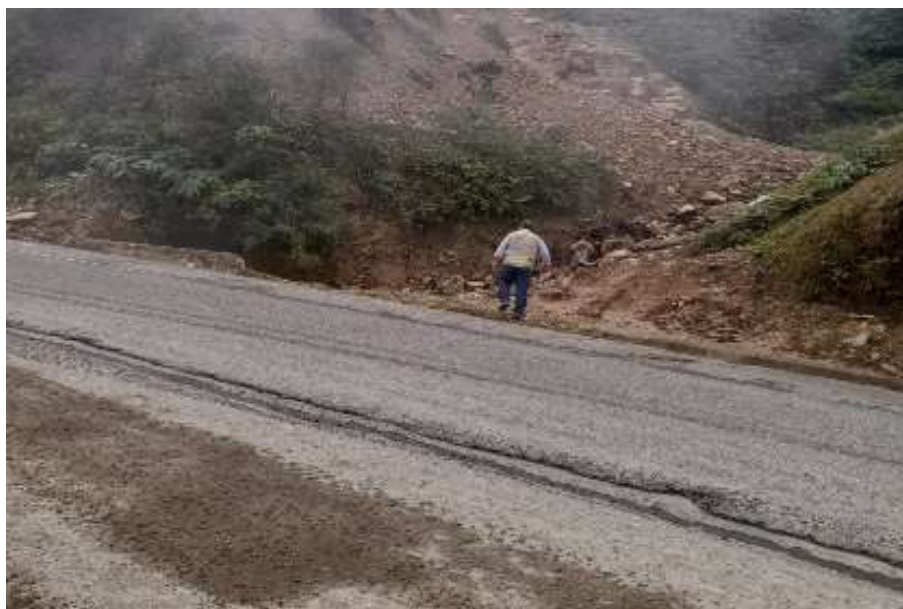
Fotografía 21: Carpeta asfáltica en mal estado PR 44+900 – PR 45+100.
