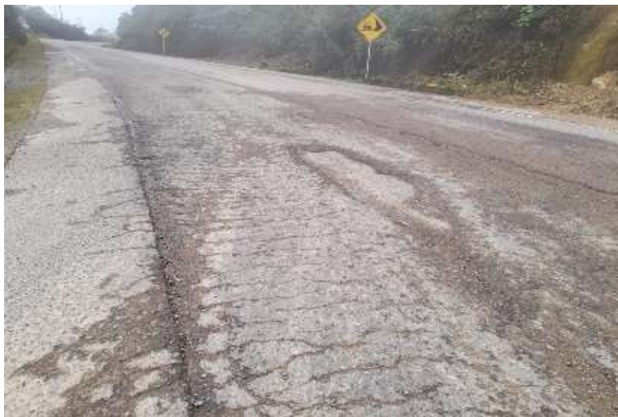
Fotografía 18: Tramo transitable, Carpeta asfáltica con desgaste, parcheo localizado, piel de cocodrilo, zona de alta humedad y mucha neblina PR 43+000 – PR 44+700.
