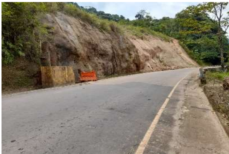
Fotografía 39: Zona de falla, derrumbe talud superior PR 80+000 – PR 80+150.
