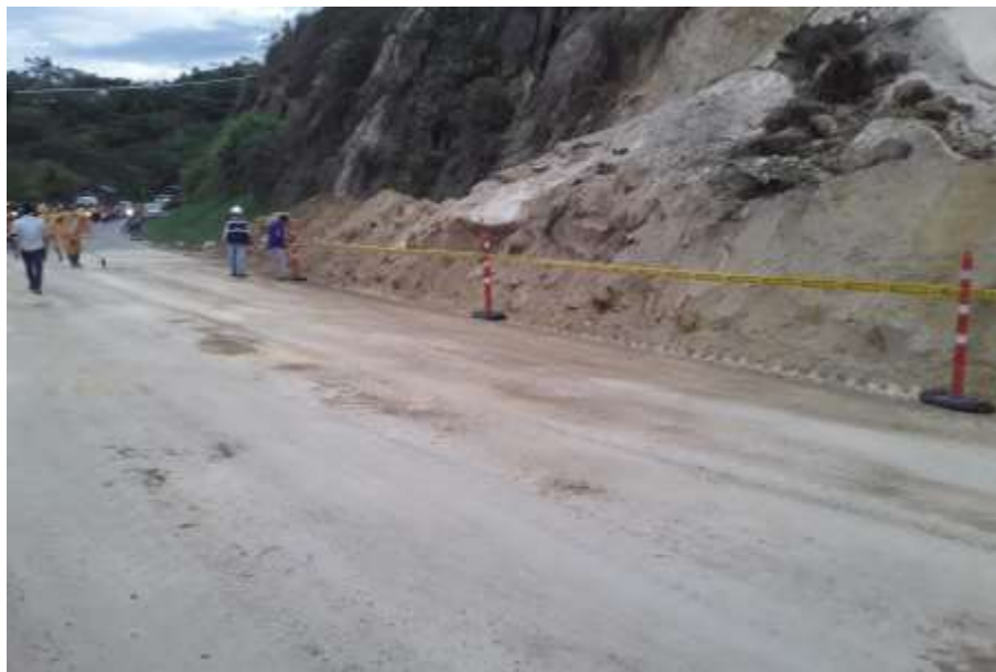
Fotografía 44: Intervención para retiro de derrumbe presentado en la PR 4+500 ruta 2003A.
