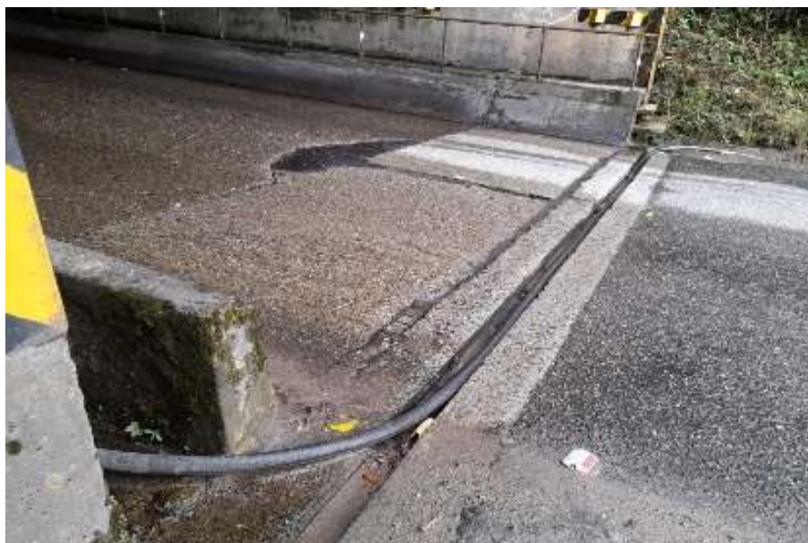
Fotografía 25: Túnel No. 3 (Long 110,8m) requiere juntas de dilatación portales de entrada y salida PR 47+816 – PR 47+926,8.
