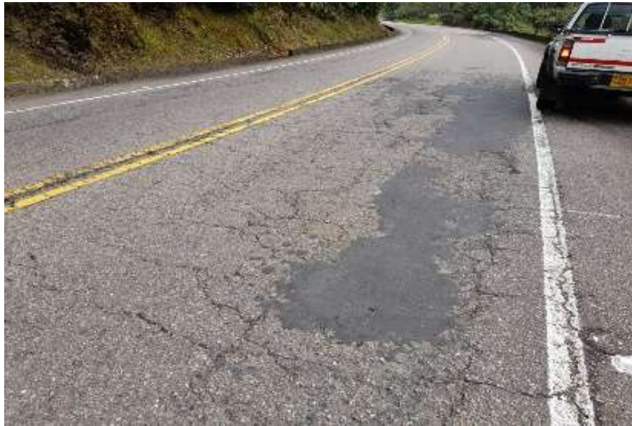
Fotografía 28: Carpeta asfáltica en mal estado, presenta fisuras, baches, piel de cocodrilo PR 49+500 – PR 50+600.
