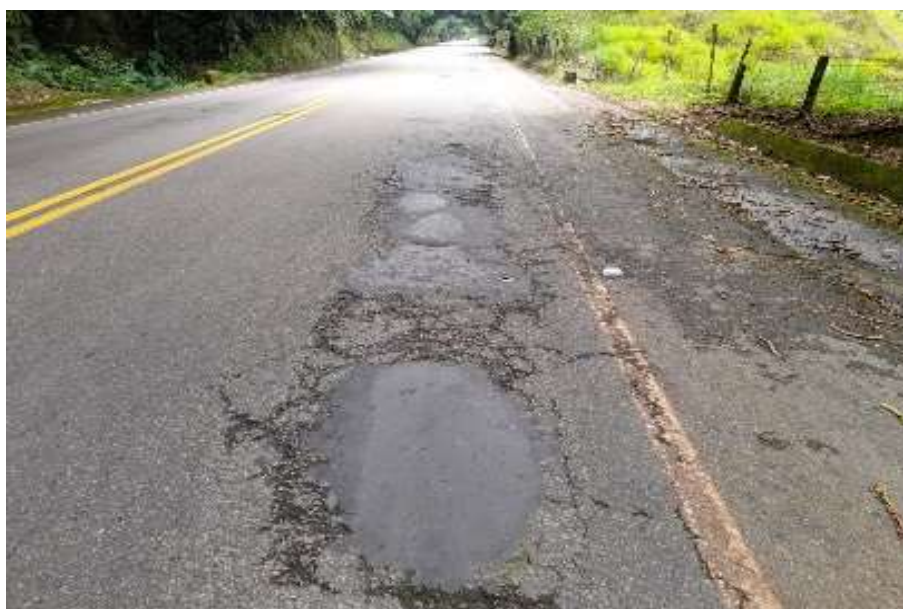
Fotografía 37: Carpeta asfáltica en mal estado, presenta desgaste, baches, fisuras, piel de cocodrilo, parcheos localizados PR 73+600 – PR 73+900.
