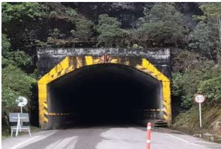
Fotografía 23: Túnel No. 1 (Long 241m) requiere juntas de dilatación portales de entrada y salida PR 45+360 – PR 45+601.
