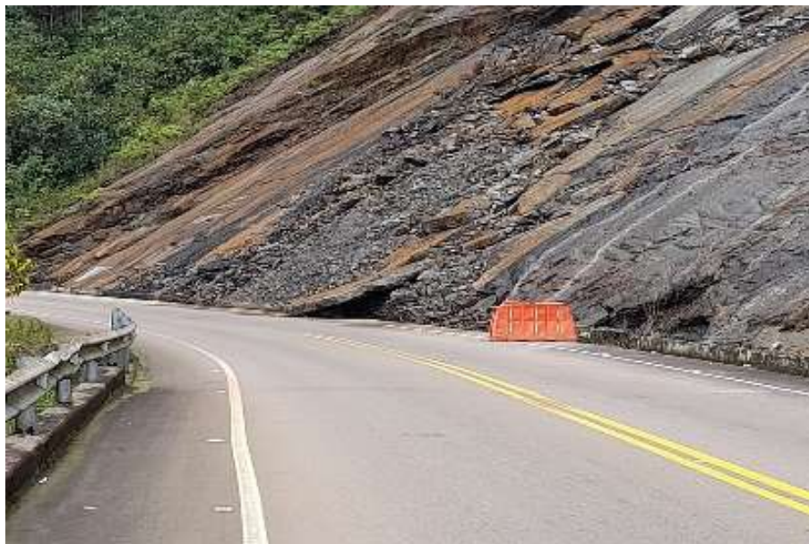
Fotografía 29: Tramo en buen estado, transitable, presenta algunas fisuras carril derecho PR 56+000 - PR 56+300, puente El Mirador PR 53+800, puente El Dormilón PR 54+200, PR 57+150 desprendimiento roca obstrucción carril izquierdo; PR 53+400 – PR 58+000.
