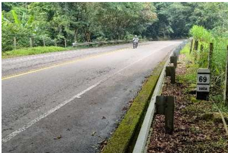
Fotografía 35: La carpeta asfáltica presenta parcheos localizados, fisuras, ondulaciones, deterioro principalmente del carril derecho PR 68+000 – PR 70+000.
