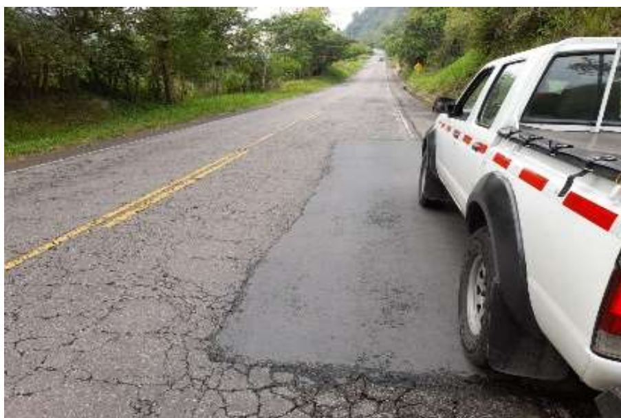
Fotografía 5: Carpeta asfáltica en mal estado, baches, fisuras, desgaste y piel de cocodrilo PR 4+000 – PR 4+500
