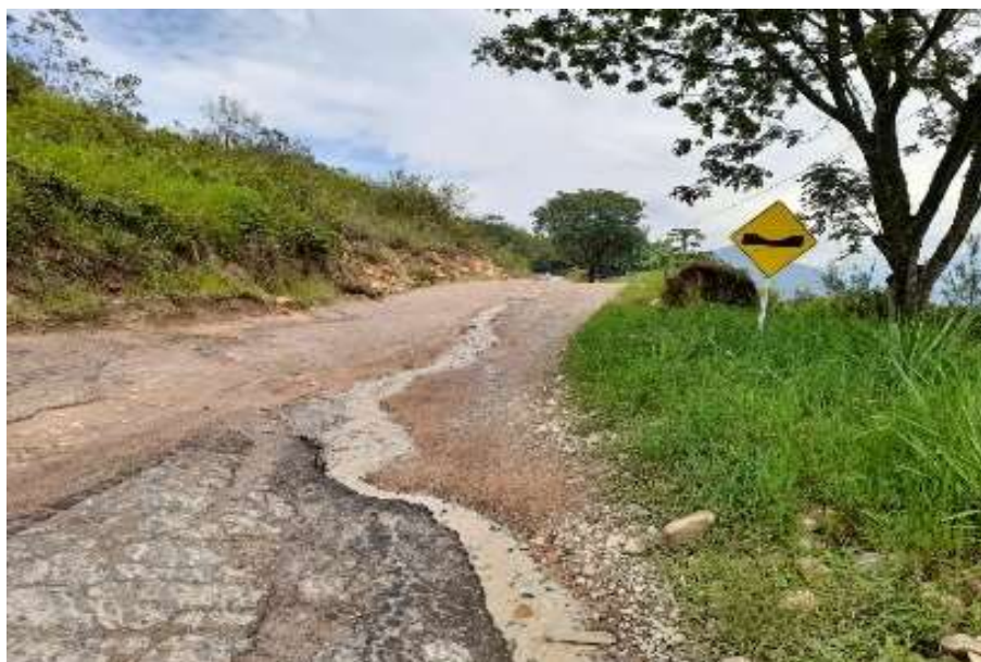
Fotografía 9: Zona de movimiento en masa, mal estado para flujo vehicular PR 20+900 – PR 21+350
