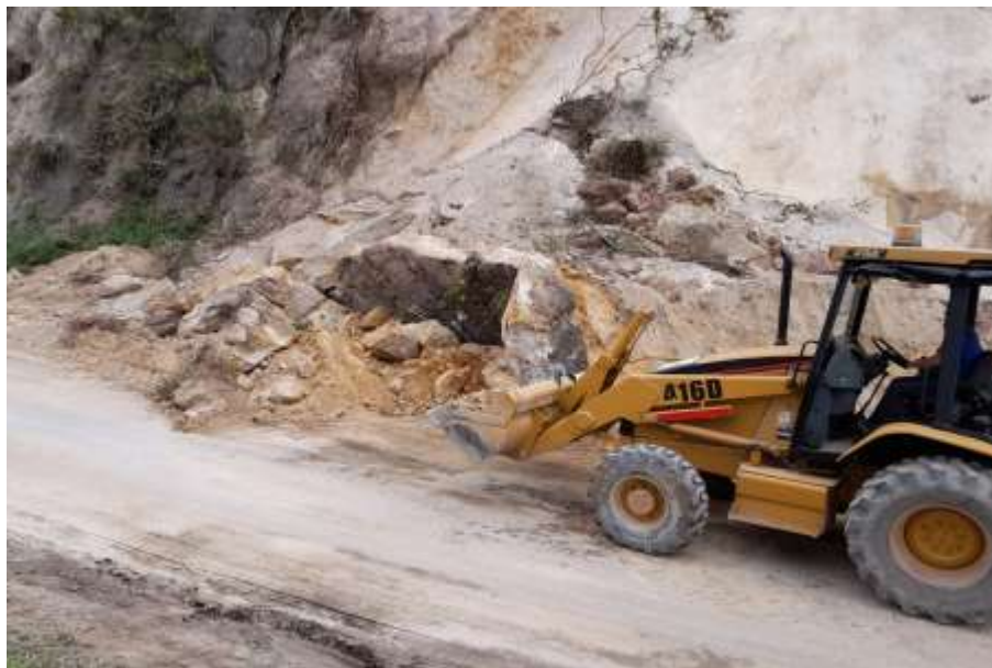
Fotografía 42: Intervención para retiro de derrumbe presentado en la PR 4+500 ruta 2003A.
