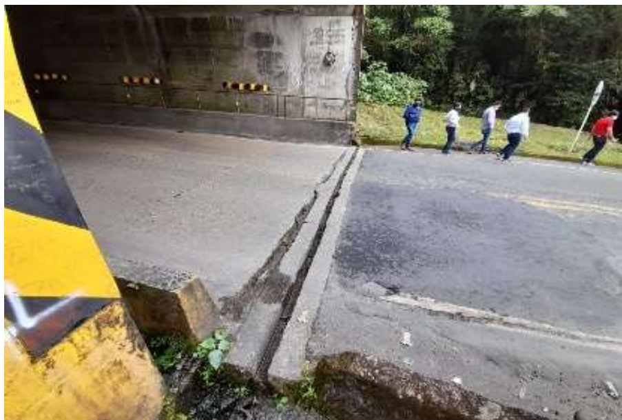
Fotografía 26: Túnel No. 4 (Long 172m) requiere juntas de dilatación portales de entrada y salida PR 48+055 – PR 48+227.
