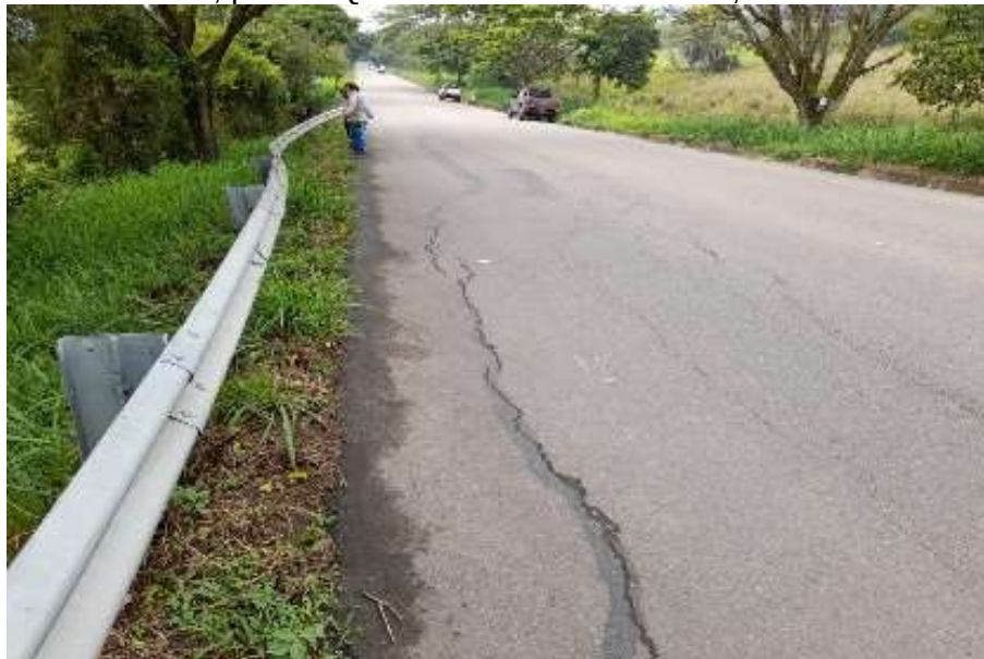
Fotografía 7: Hundimiento banca inferior del terraplén carril izquierdo, defensa metálica en mal estado, paso tubería gas, PR 15+950 – PR 16+000
