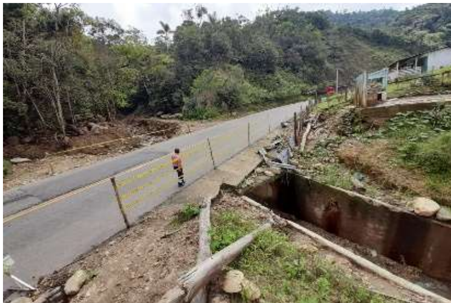
Fotografía 14: Obra de cruce (box culvert) saturado por material de avalancha, se evidencia zona crítica PR 35+500
