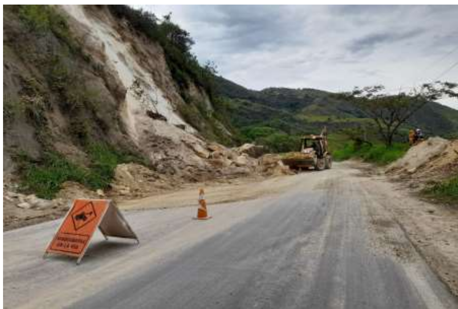
Fotografía 43: Intervención para retiro de derrumbe presentado en la PR 4+500 ruta
