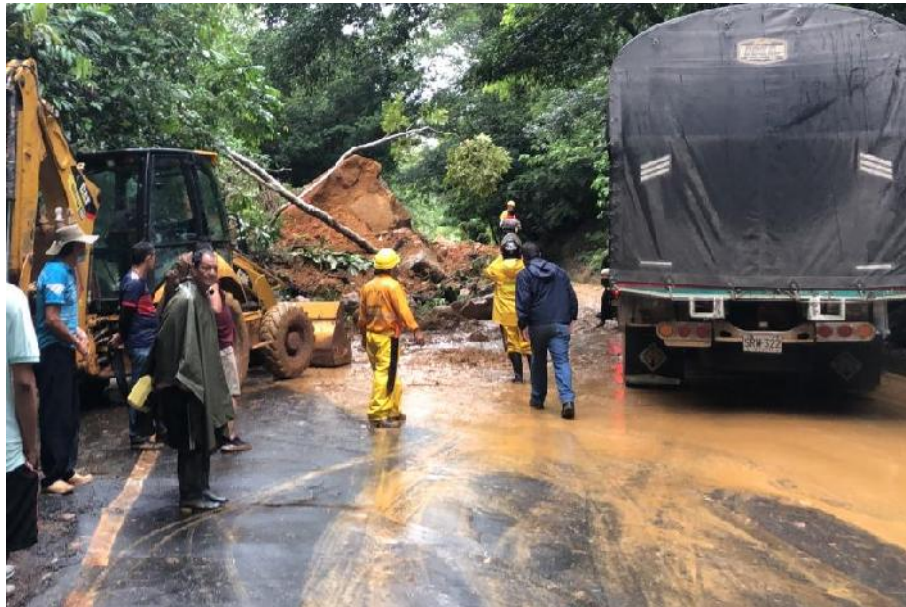
Fotografía 4: Remoción de material proveniente de derrumbe PR 77+950 Ruta 2003 A.
