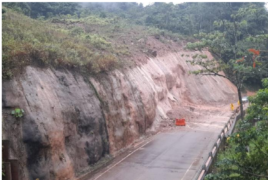
Fotografía 7: Derrumbe PR 80+100 Ruta 2003 A.
