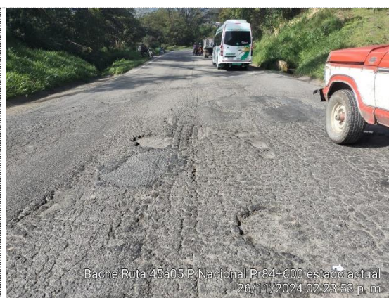
PR84+0600 – PR84+0810, Puente Nacional, estado inicial de la vía (27/11/24)
