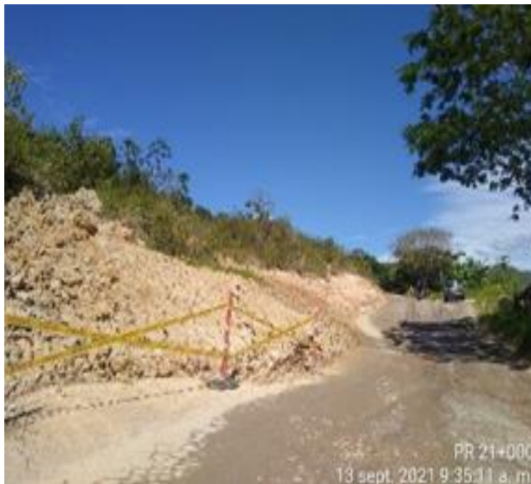
Fotografía 1: Falta mantenimiento PR 21+020 Ruta 2003 A sector Huila.
