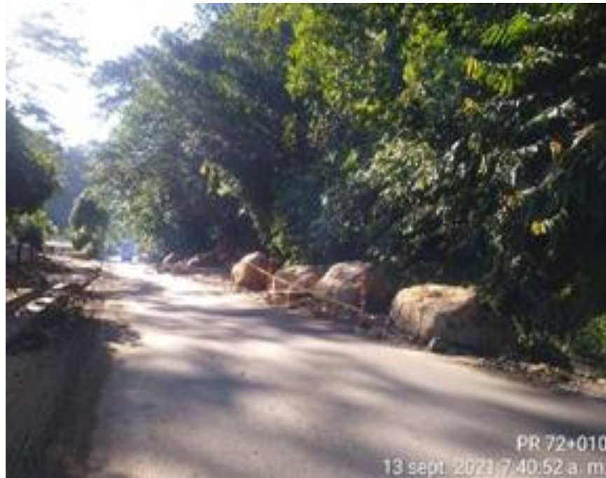
Fotografía 4: Pendiente retiro de rocas PR 72+000 Ruta 2003 A.
