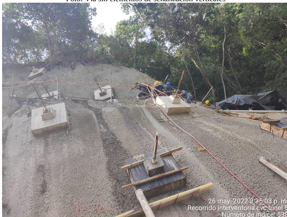
Foto: Trabajo en alturas sin EPPC
