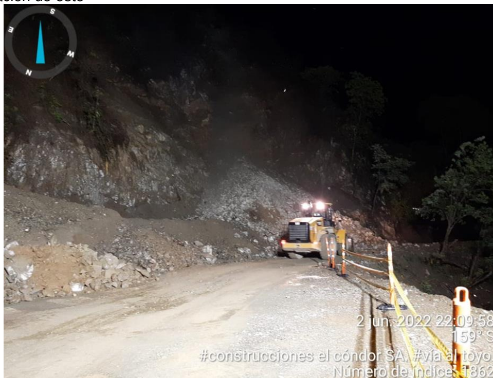
Foto: atención del contratista a la caída de rocas
