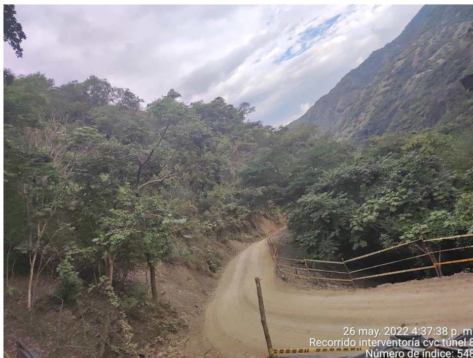
Foto: Vía sin elementos de señalización verticales
