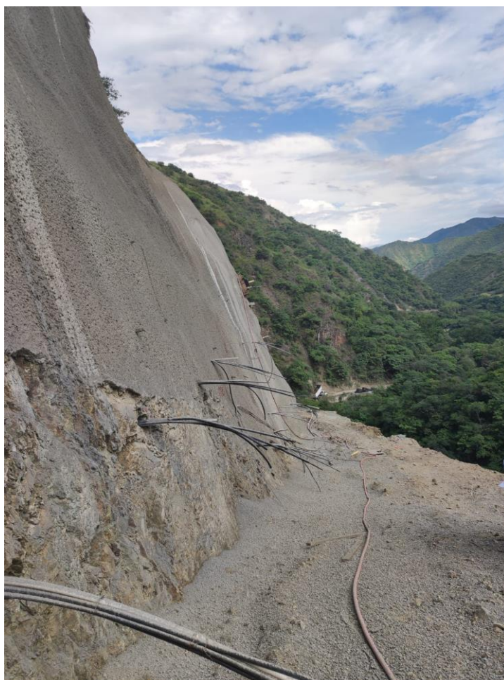
Foto: Falta de señalización y demarcación de frentes de obra
