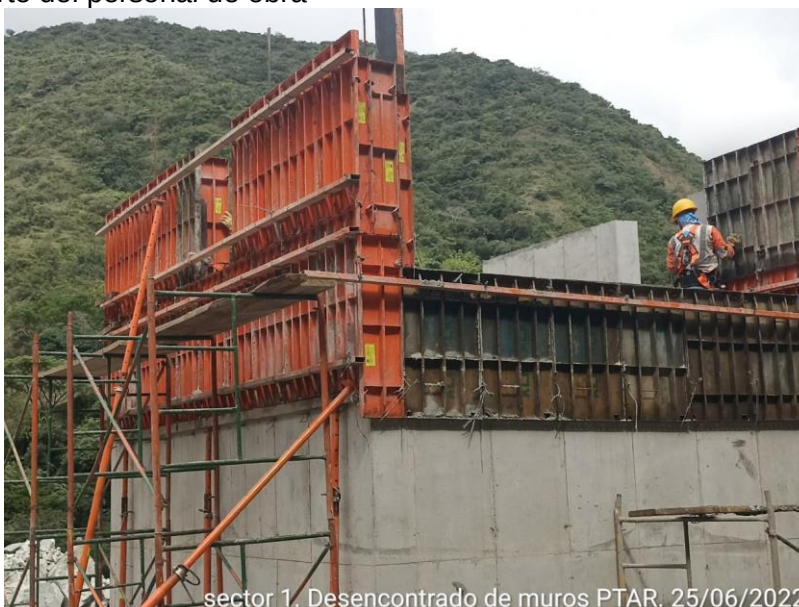
sector 1. Desencontrado de muros PTAR. 25/06/2022
