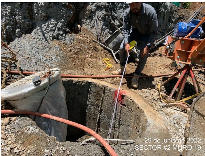
Foto personal sin el equipo y anclajes adecuados para el trabajo en alturas
