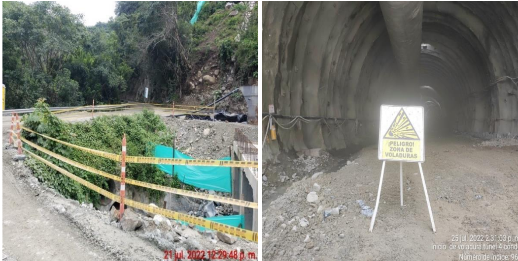
Foto: Señalización de seguridad en borde de vía con cinta de señalización y señalización de advertencia de peligro de voladuras.
