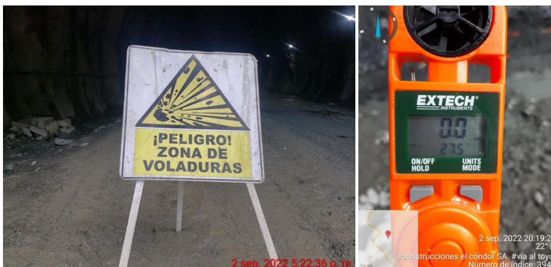
Imágenes: Verificación de la señalización instalada y las mediciones de la calidad del aire dentro de los túneles antes del inicio de actividades críticas.
