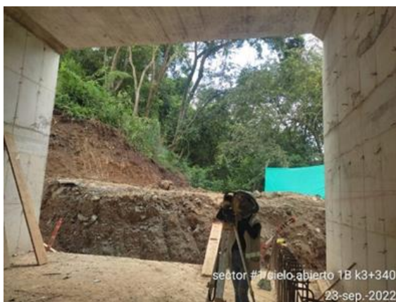
Foto No 37: ielo abierto 1B k3+340 levantamiento de fisuras losa superior paso vehicular
