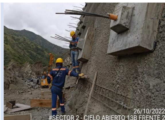
Foto 4-3 K12+356 -K13+664, estado inicial
