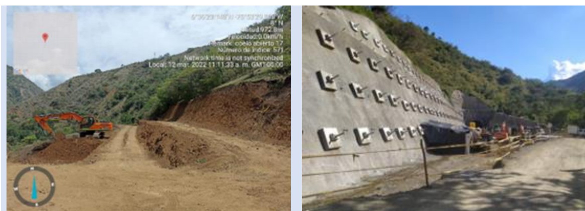
Foto 4-5 K15+246 – K15+506, estado inicial
