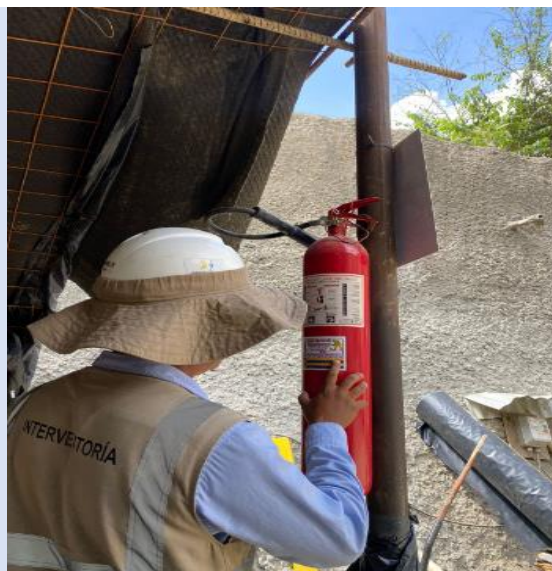
Foto 4-47 Tunel 68 PS. Inspeccion de extintores.
