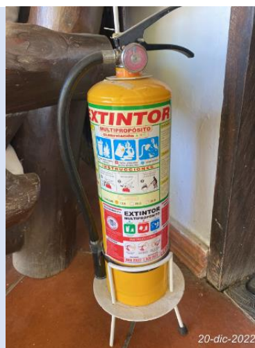
Foto 5-2 Oficina de Interventoría. Extintores disponibles para combatir conatos de incendio.
