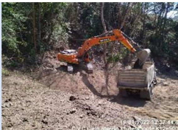
Foto 4-1 K12+356 -K13+664, estado inicial
